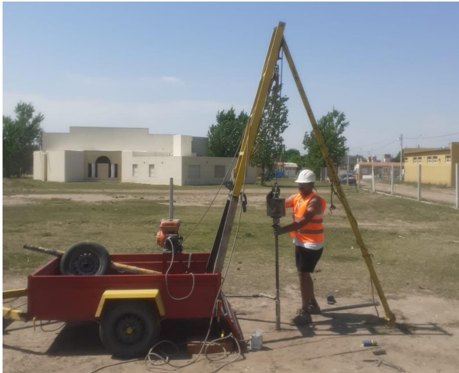
Equipo montado en terreno en S1. Operarios con elementos de seguridad personal.
