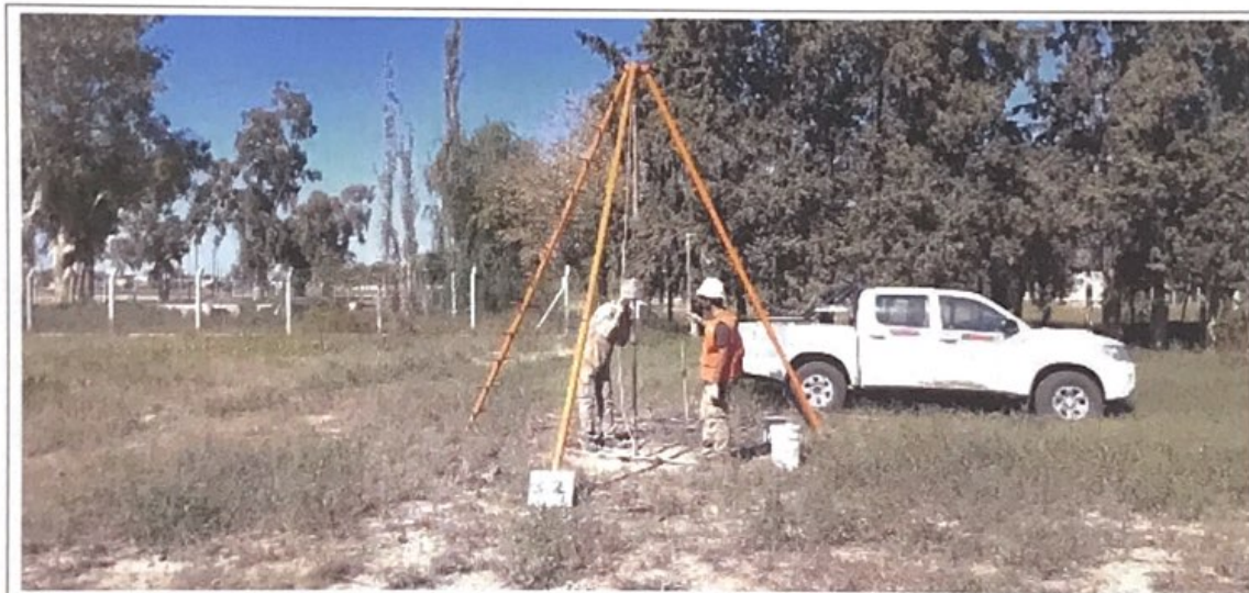
Fotografía N°16: Vista de la posición en el terreno del Sondeo S.2. Se observan los trabajos de perforación y toma de muestra, como así también el ensayo de penetración estándar (SPT).
