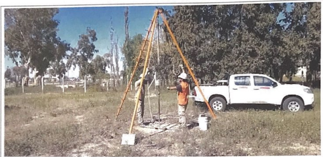
Fotografía N°17: Vista de la posición en el terreno del Sondeo S.2. Se observan los trabajos de perforación y toma de muestra, como así también el ensayo de penetración estándar (SPT).
