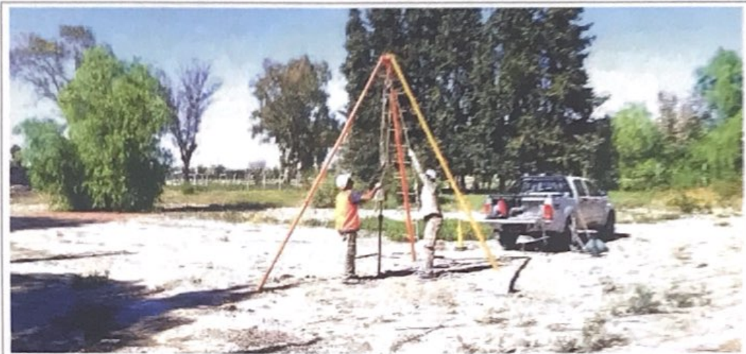
Fotografía N°11: Vista de la posición en el terreno del Sondeo S.1. Se observan los trabajos de perforación y toma de muestra, como así también el ensayo de penetración estándar (SPT).
