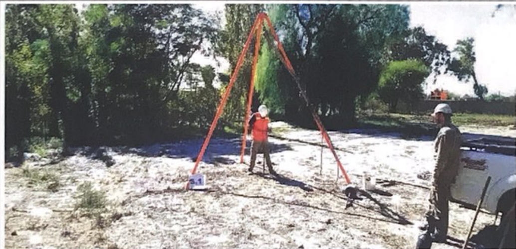
Fotografía N°10: Vista de la posición en el terreno del Sondeo S.1. Se observan los trabajos de perforación y toma de muestra, como así también el ensayo de penetración estándar (SPT).
