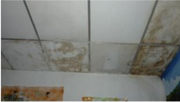
IMAGEN 1: ESTADO DE CIELO FALSO
