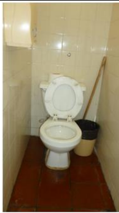
Inodoro a reemplazar
