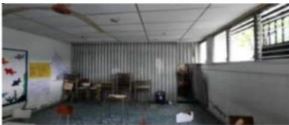
DESMONTAJE DE DIVISION METÁLICA, SUMINISTRO E INSTALACION DE DIVISION TABLA ROCA NUEVA Fotografía No. 3
