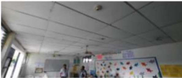
REPARACIÓN DE CIELO FALSO, CAMBIO DE TECHO, INSTALACION DE LUMINARIAS. Fotografía No. 1
