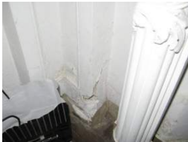
55-FALTANTE PARCIAL-MATERIAL DISGREGADO-PERDIDA DE RELIEVE
