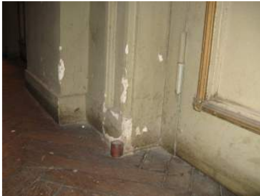
34-FALTANTE PARCIAL-PERDIDA DEL RELIEVE
