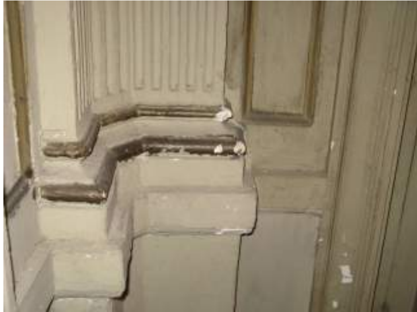
81-FALTANTE PARCIAL-MICROORGANISMOS-PERDIDA DEL RELIEVE
