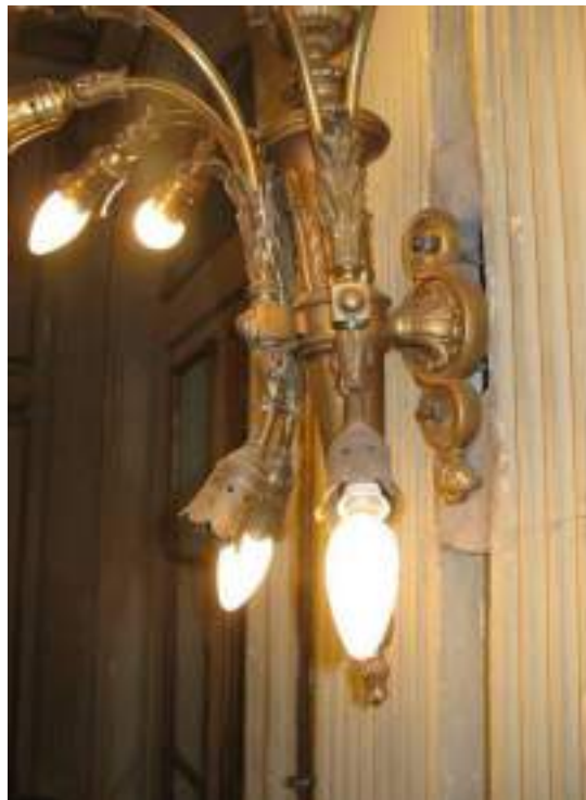
4-FIJACION NO ORIGINAL-FALTANTE DE LAMPARA
