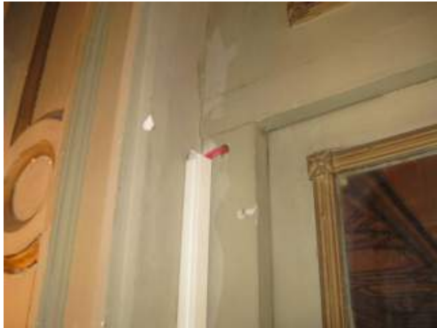
5-INSTALACION NO ORIGINAL-JUNTA ABIERTA EN CARPINTERIA-PERFORACION
