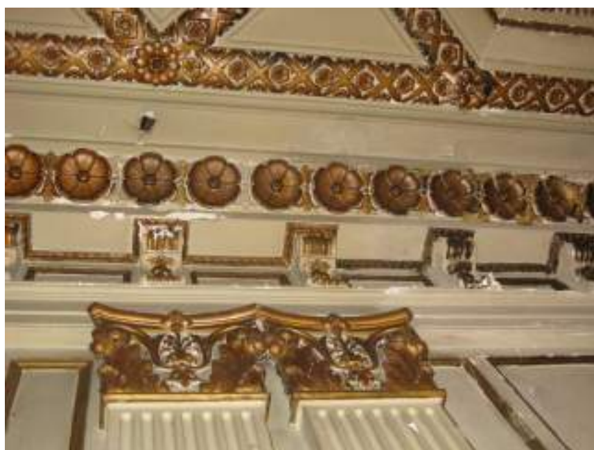
71.-MATERIAL DISGREGADO-EFLORESCENCIA DE SALES SOLUBLES
