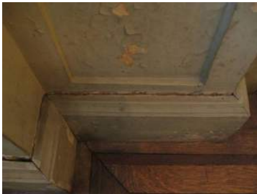
34-DESPRENDIMIENTO DE CAPA PCTORICA-ZOCALOS DESPRENDIDOS
