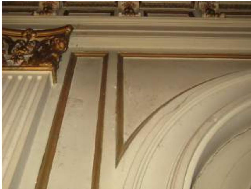
45-MANCHAS DE HUMEDAD-MICROORGANISMOS
