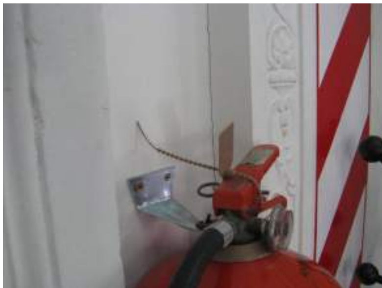
21-FISURAS-INSTALACION NO ORIGINAL-PERFORACIONES
