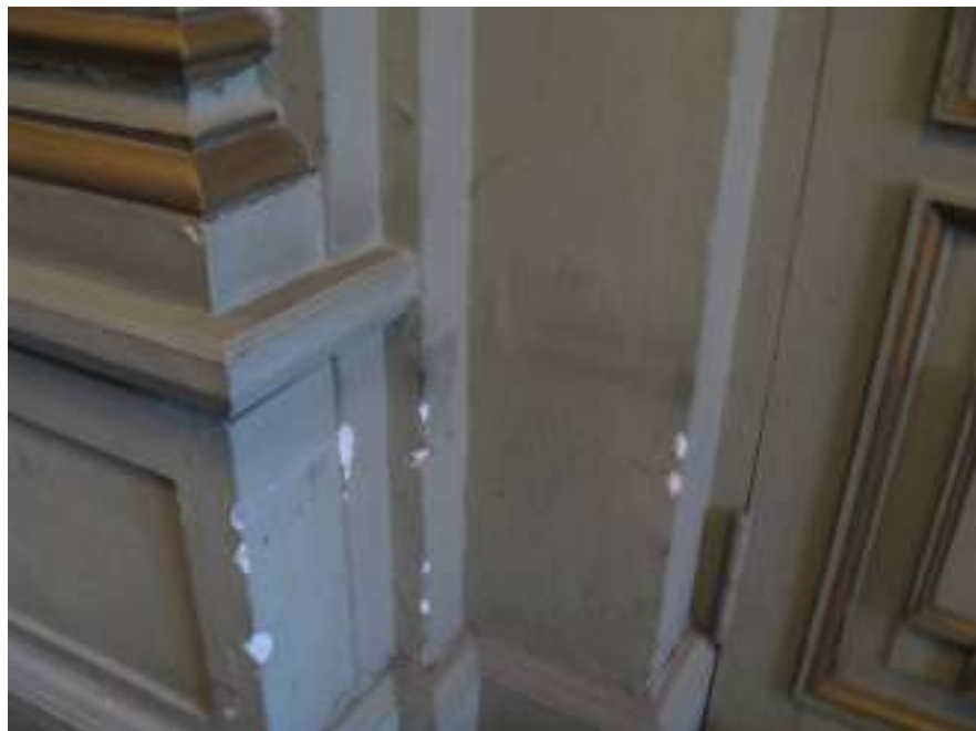
8-FALTANTE PARCIAL-FISURAS-PERDIDA DE RELIEVE
