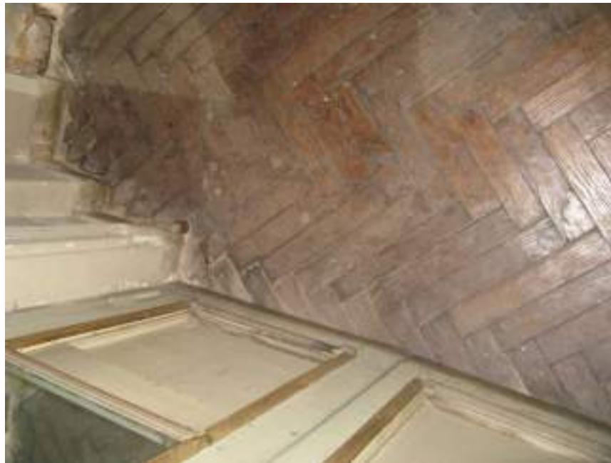
5-PA-JUNTAS ABIERTAS-MANCHAS DE HUMEDAD
