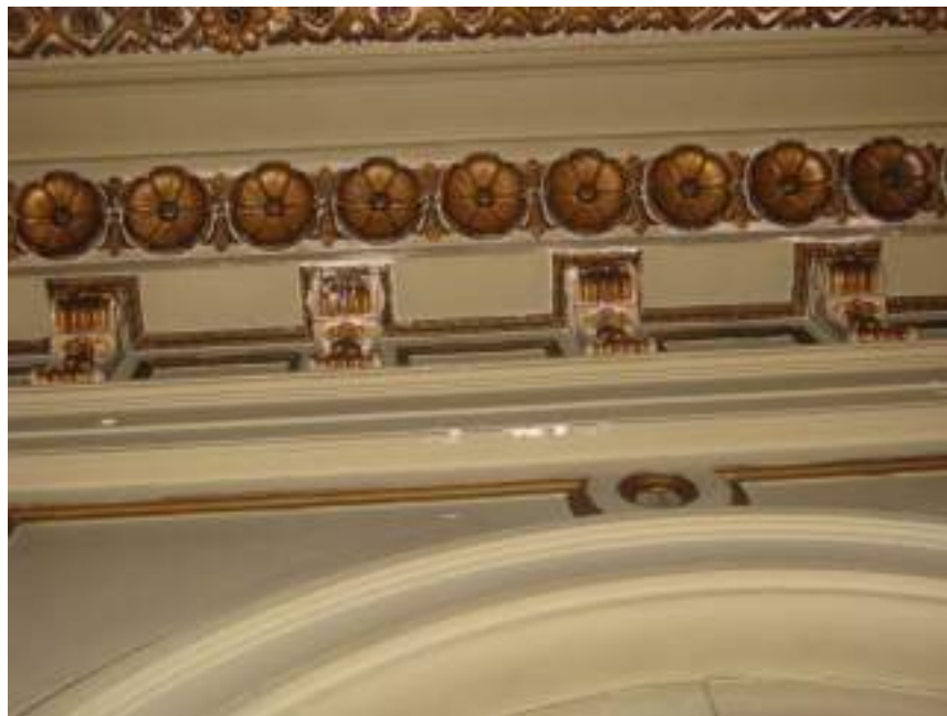
66-MATERIAL DISGREGADO-EFLORESCENCIA DE SALES SOLUBLES
