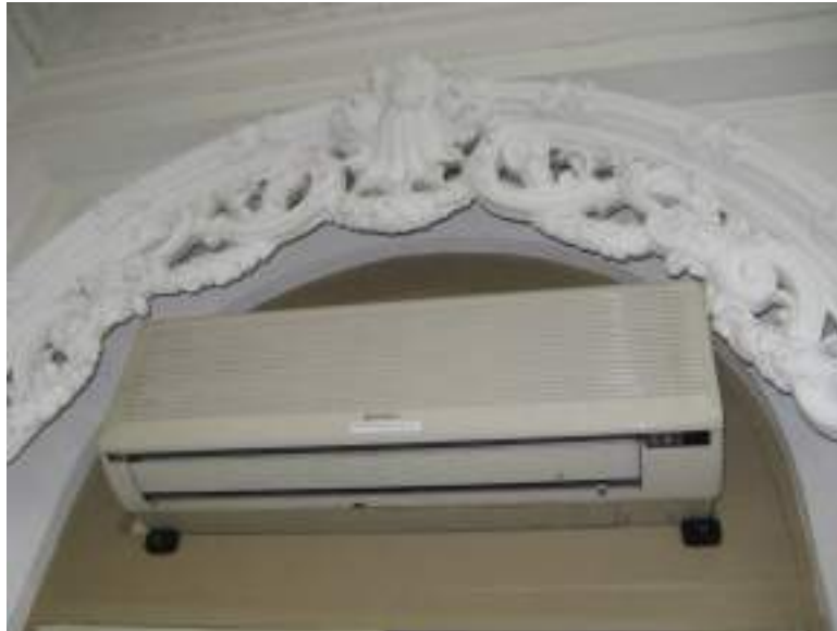
36-INSTALACION NO ORIGINAL
