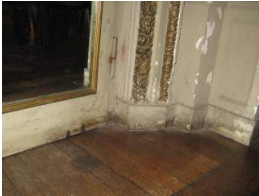
69-MANCHAS DE PINTURA-PERDIDA DE RELIEVE-RAYADURAS
