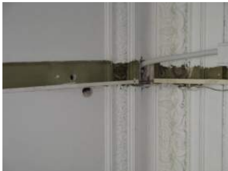
39-INSTALACION NO ORIGINAL-INTERVENCION PRECEDENTE-PERFORACIONES
