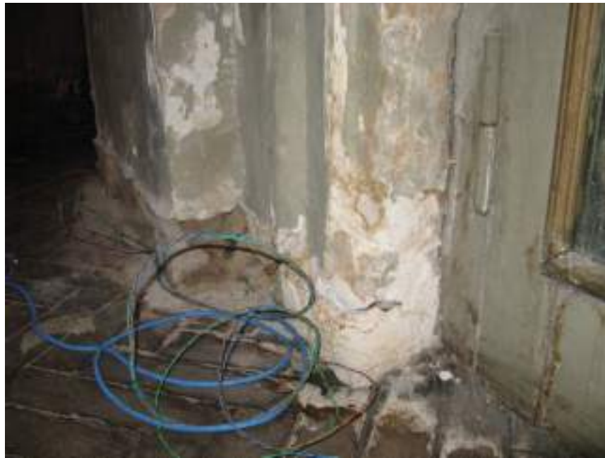
55-INSTALACION OBSOLETA-MATERIAL DISGREGADO—SALES SOLUBLES EN SUPERFICIE
