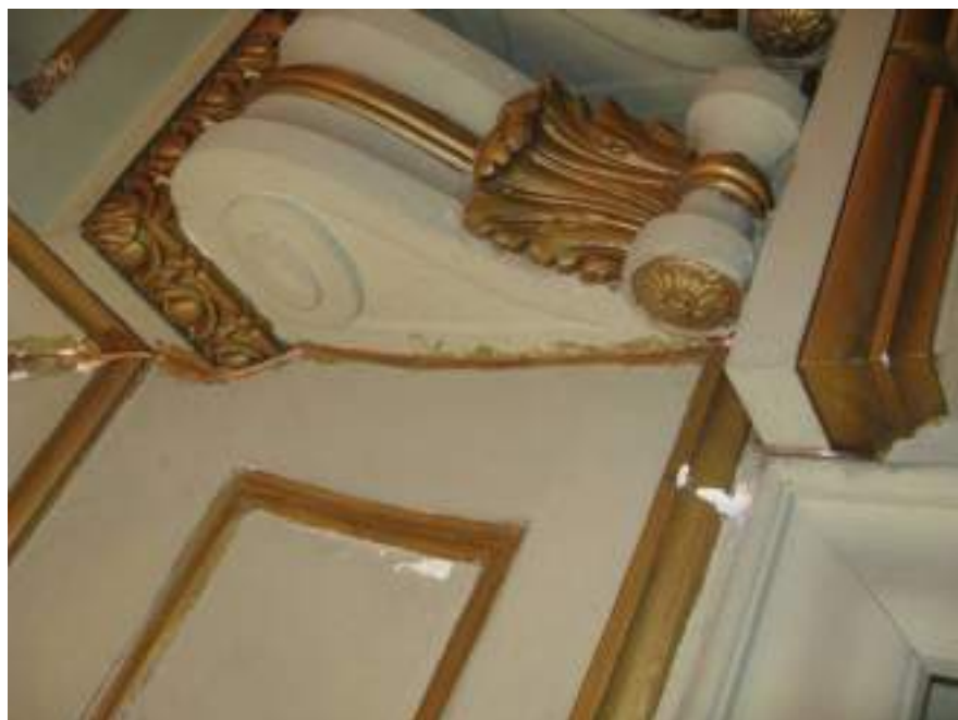
25-FALTANTE PARCIAL-INSTALACION NO ORIGINAL-INTERVENCIONPRECEDENTE
