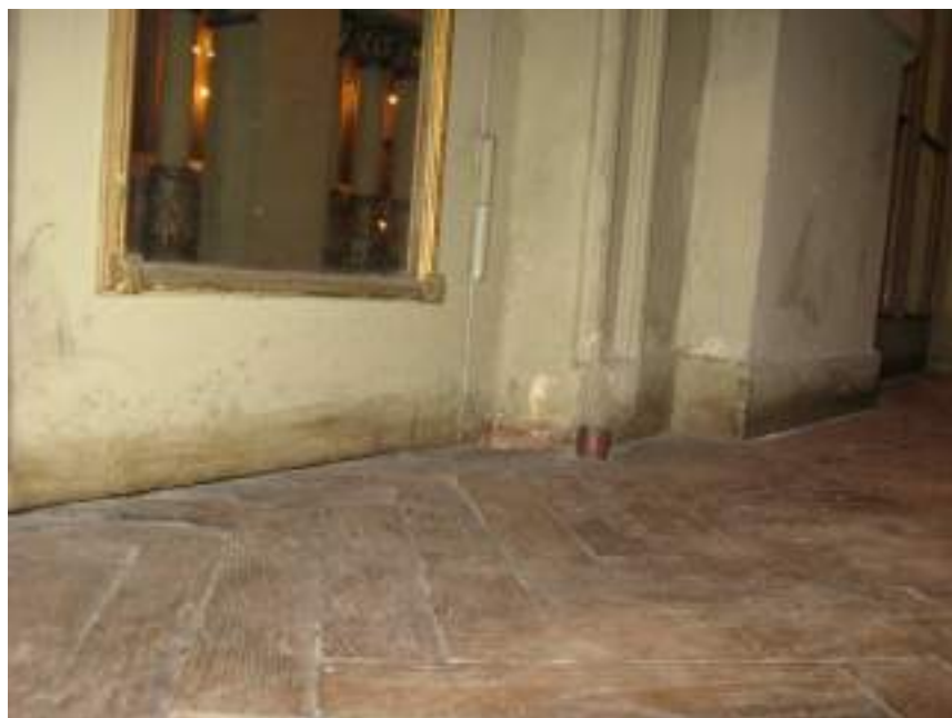
38-FISURAS-MATERIAL DISGREGADO-PERDIDA DEL RELIEVE
