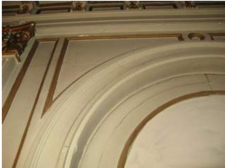
26-FISURAS-JUNTA ABIERTA EN CARPINTERIA
