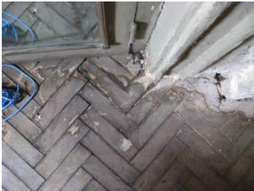
8-PA-MANCHAS DE HUMEDAD-PUTREFACCION
