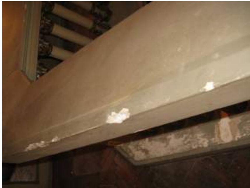
60-CAPA PICTORICA DISGREGADA-FALTANTE PARCIAL
