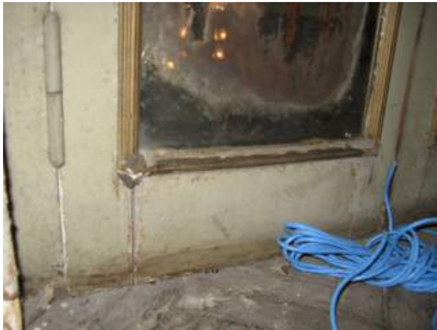
61-ALTERACION DEL PLATEADO-FALTANTE PARCIAL-MATERIAL DISGREGADO
