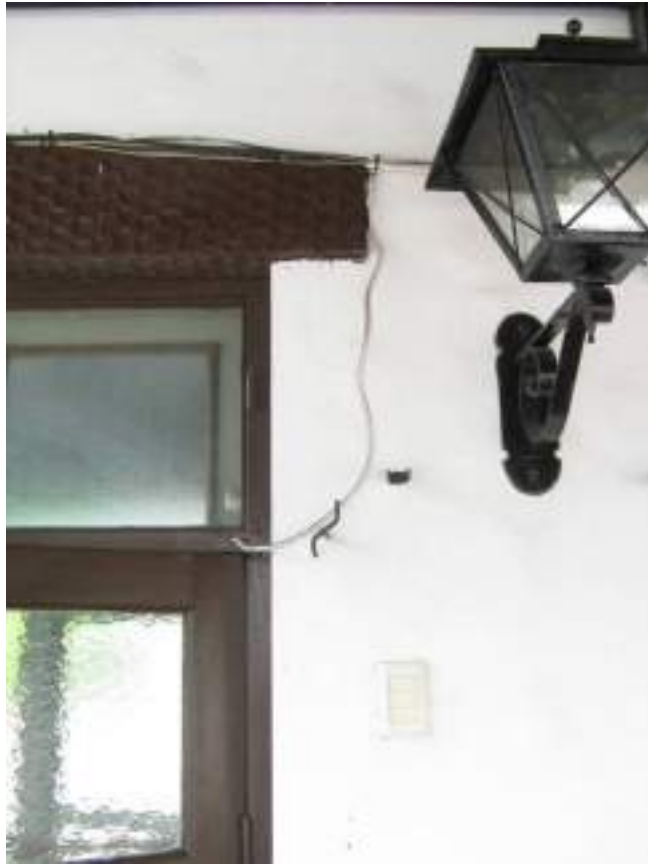
25-INSTALACION NO ORIGINAL-PERFORACIONES
