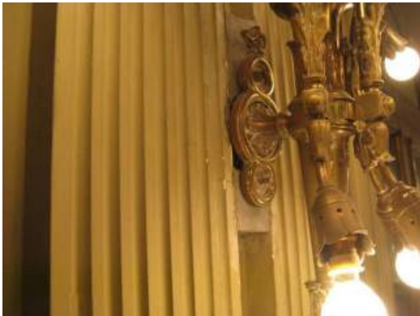
17-FALTANTE PARCIAL-INTERVENCION PRECEDENTE
