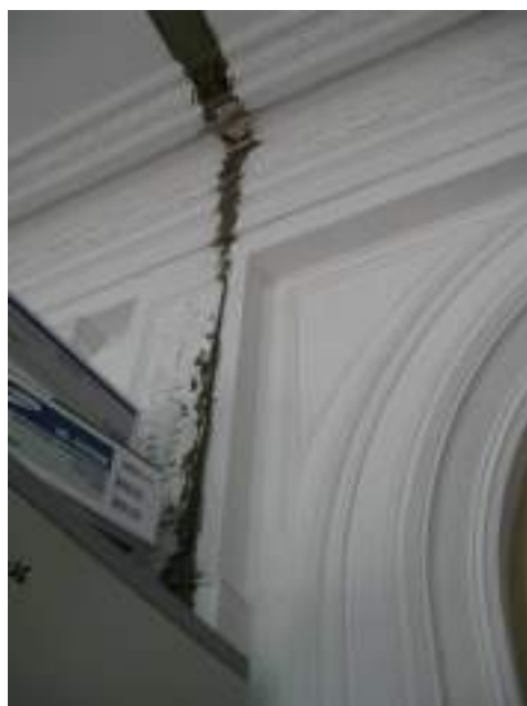
9-FALTANTE PARCIAL-INTERVENCION PRECEDENTE
