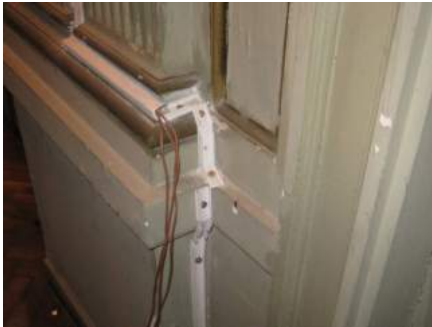
74-INSTALACION NO ORIGINAL-PERFORACIONES
