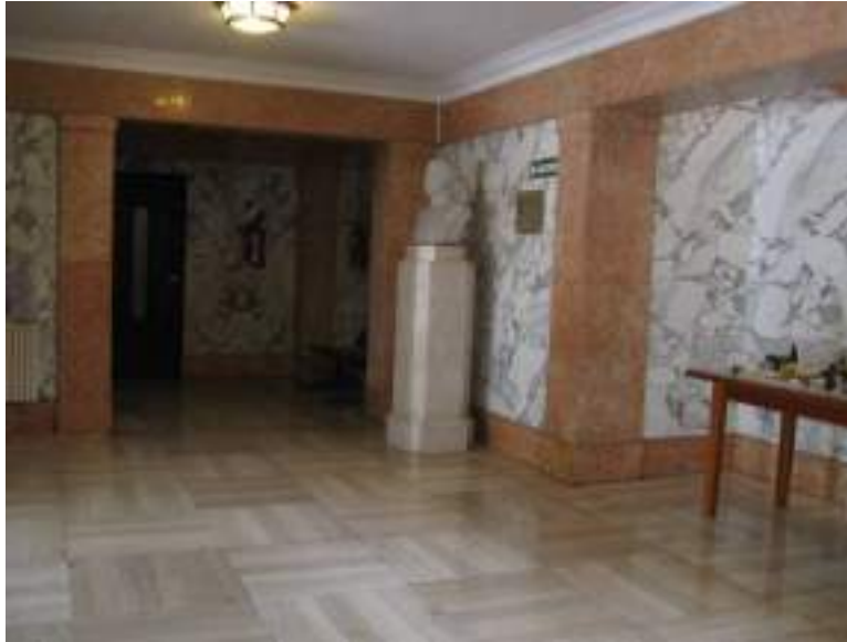
1-FALTANTE PARCIAL - JUNTA ABIERTA – SUCIEDAD SUPERFICIAL
