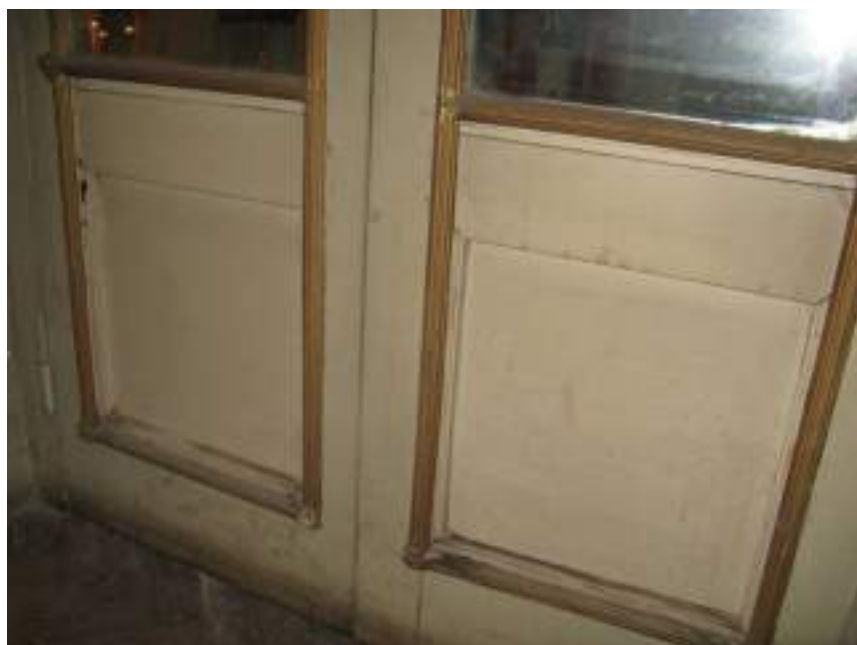
33-VIDRIO FALTANTE-FALTANTE PARCIAL-FALTANTE TOTAL
