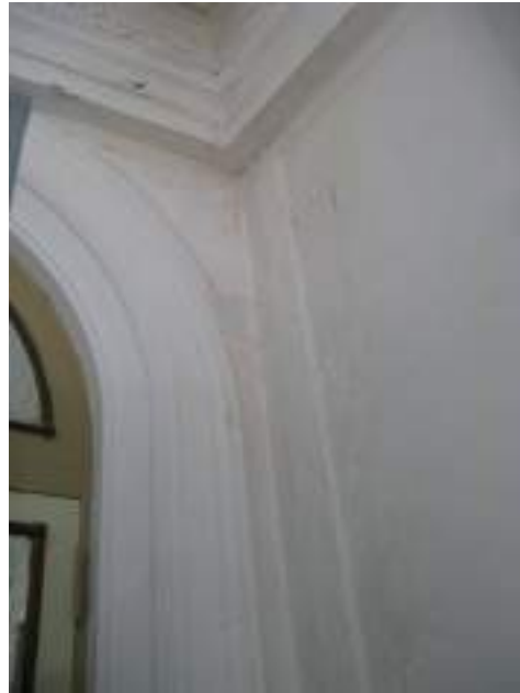
12-CAPA PICTORICA DISGREGADA-MANCHAS DE HUEMDAD
