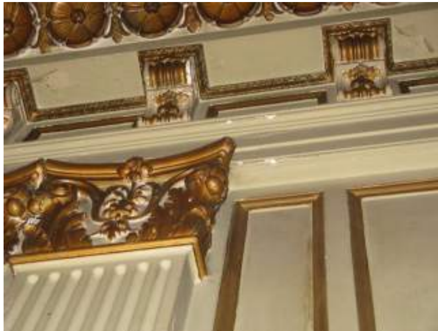
24-EFLORESCENCIAS DE SALES SOLUBLES
