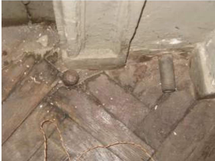
12-PA-JUNTAS ABIERTAS-MANCHAS DE HUMEDAD
