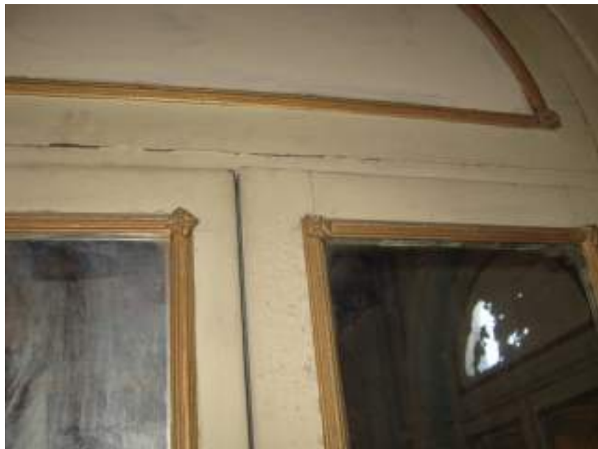
27-FALTANTE PARCIAL-JUNTA ABIERTA EN CARPINTERIA-VIDRIO PINTADO
