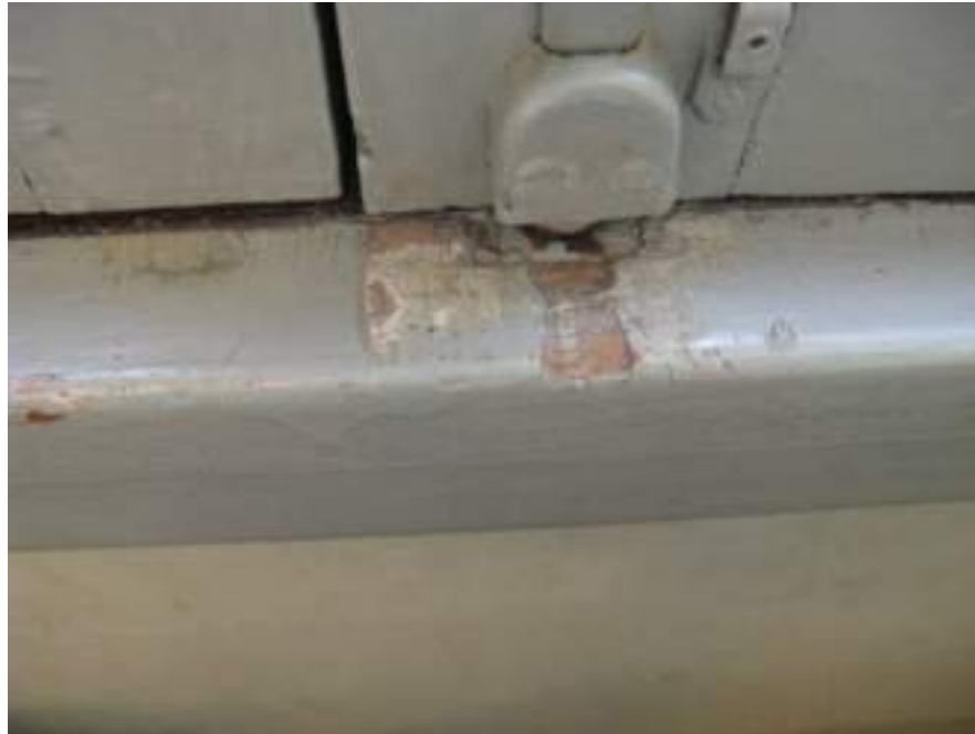
14-PERDIDA DE RELIEVE-RAYADURA
