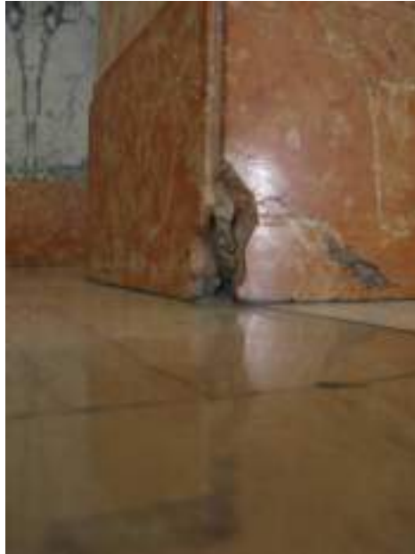
3-FALTANTE PARCIAL-JUNTA ABIERTA-SUCIEDAD SUPERFICIAL
