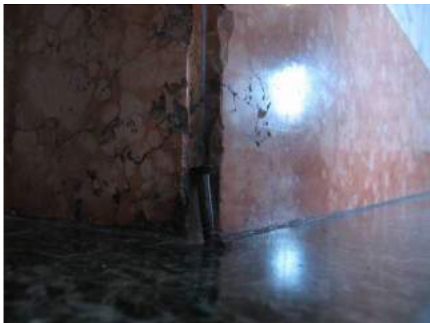
10-FALTANTE PARCIAL-INTERVENCION PRECEDENTE-PERDIDA DE RELIEVE
