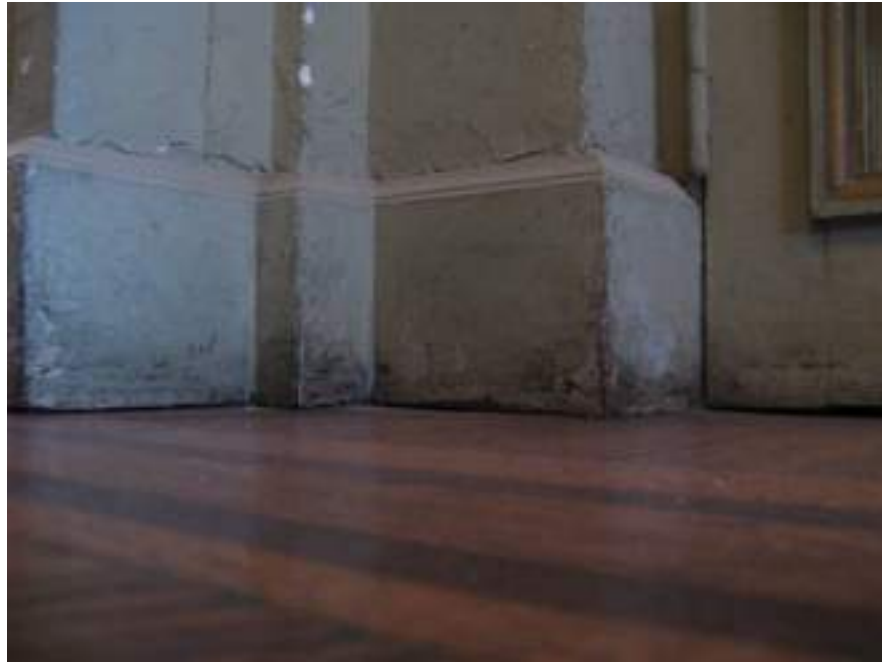
7-FISURAS-PERDIDA DE RELIEVE-RAYADURA
