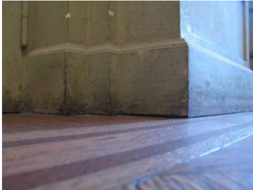
5-FALTANTE PARCIAL-PERDIDA DE RELIEVE
