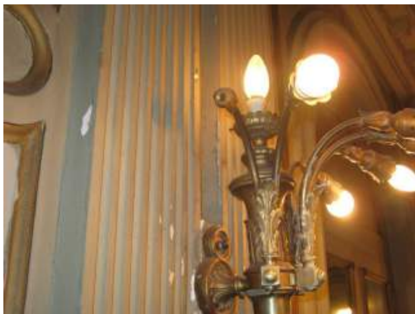
65-FALTANTE DE PORTA LAMPARA
