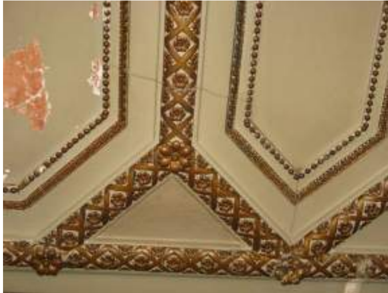
5-FISURAS-DESPRENDIMIENTO DE CAPA PICTORICA
