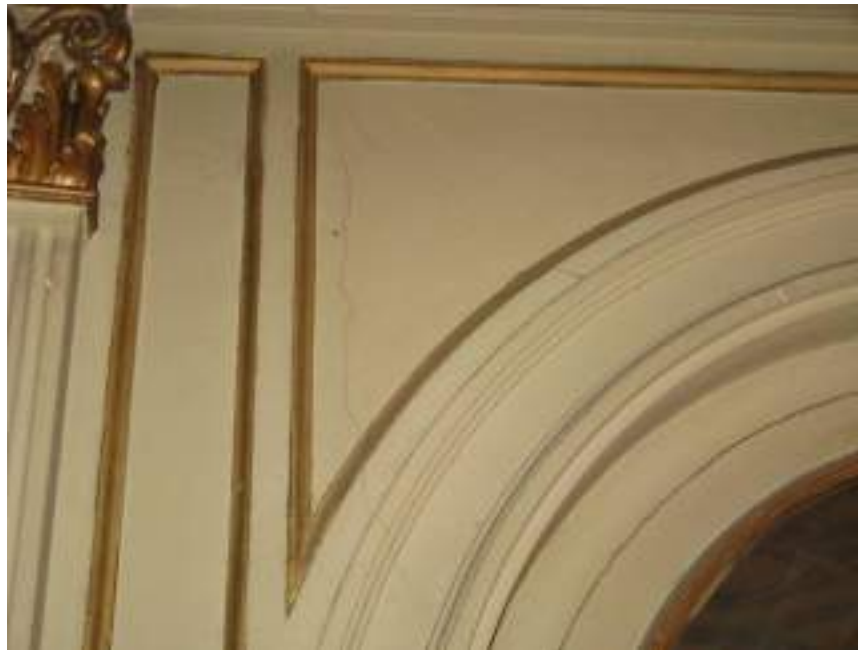
1-FISURAS-JUNTA ABIERTA EN CARPINTERIA
