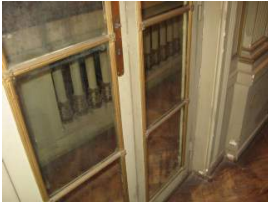
78-ALTERACION DEL PLATEADO-FALTANTE PARCIAL
