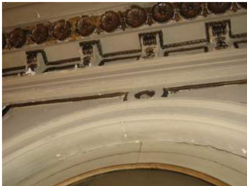
73-EFLORESCENCIA DE SALES SOLUBLES-JUNTA ABIERTA EN CARPINTERIA
