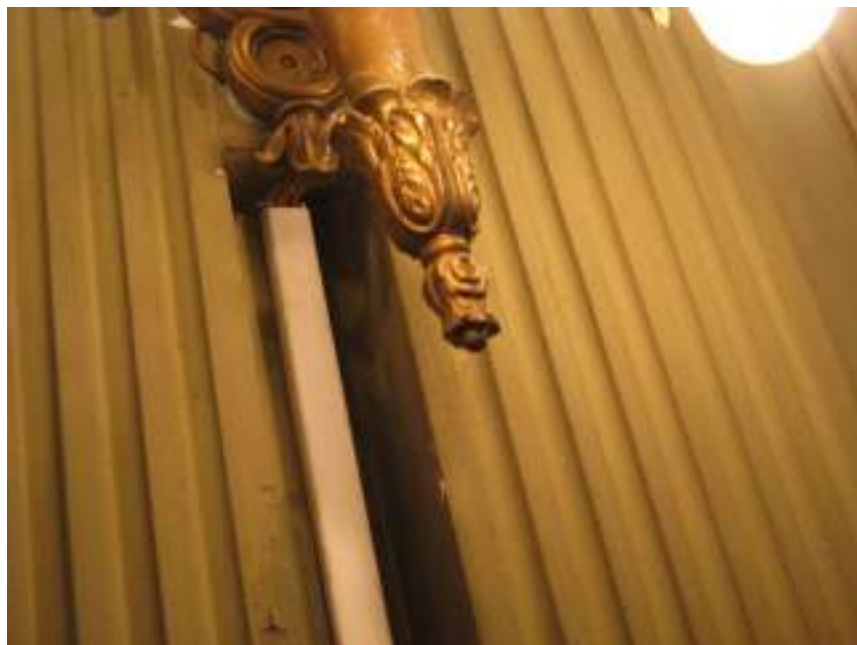
69-INSTALACION NO ORIGINAL-FALTANTE PARCIAL
