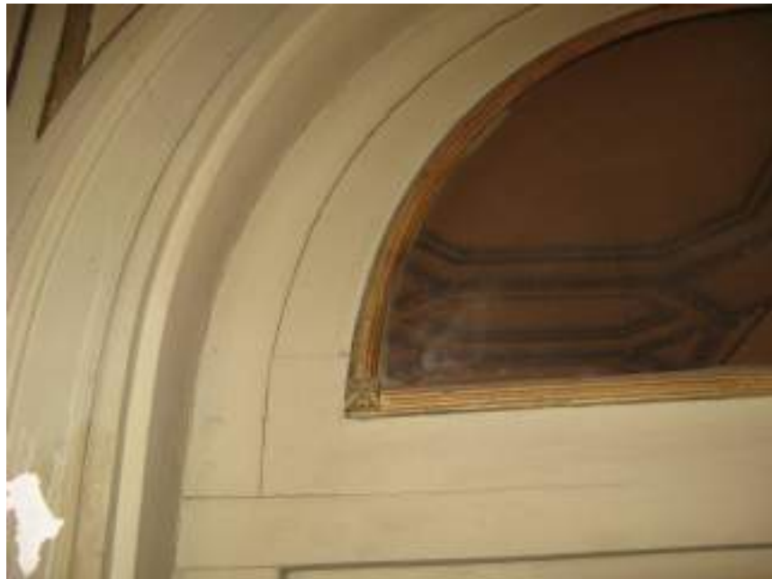
2-FISURAS-JUNTA ABIERTA EN CARPINTERIA
