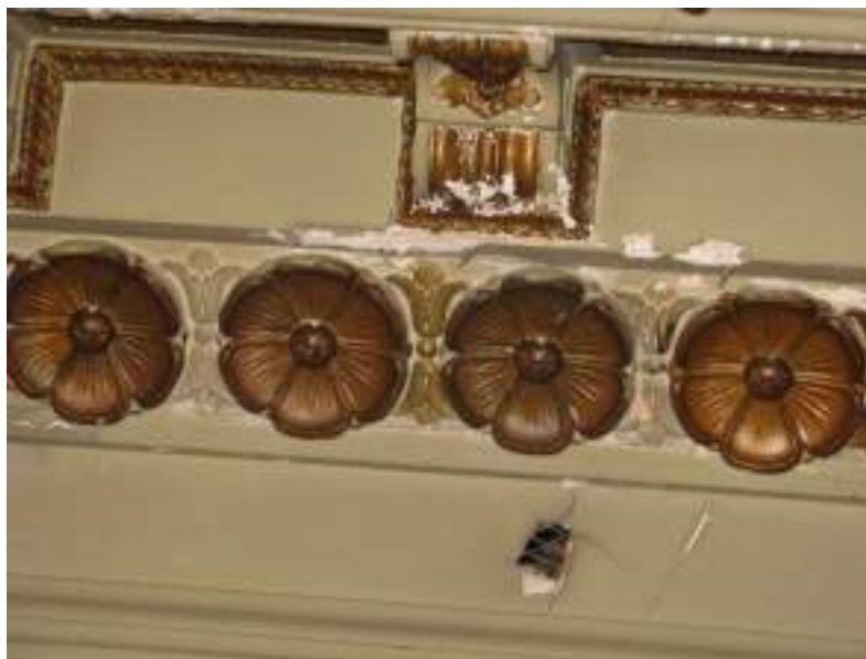
8-EFLORESCENCIA DE SALES SOLUBLES-MATERIAL DISGREGADO-PERFORACION
