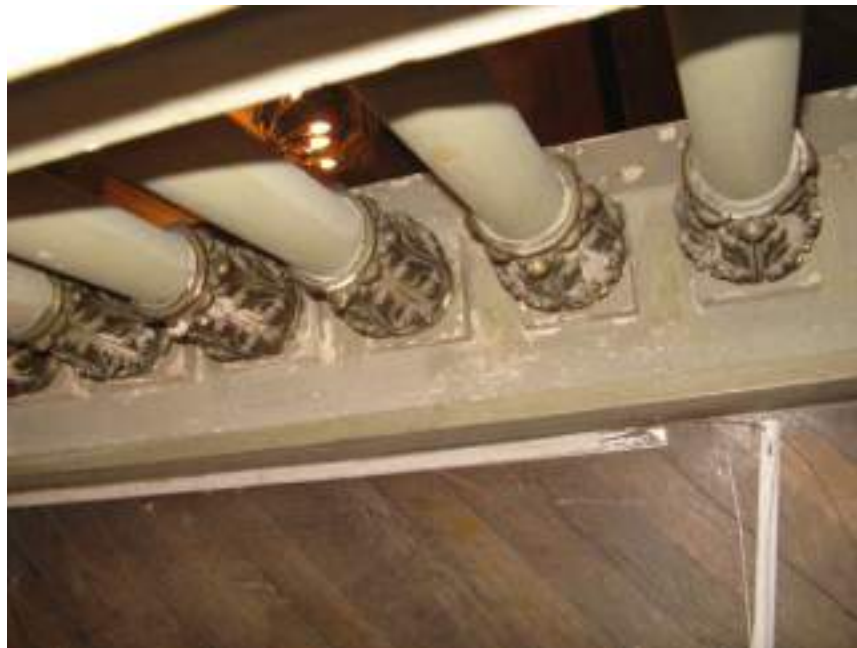
78-CAPA PICTORICA DISGREGADA
