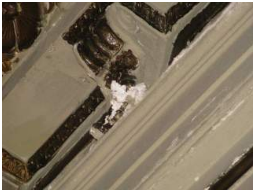
72-FALTANTE PARCIAL-MATERIAL DISGREGADO-EFLORESCENCIA DE SALES
