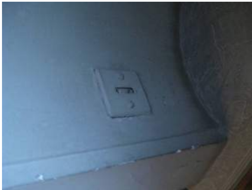
2-INSTALACION OBSOLETA-PERDIDA DE RELIEVE
