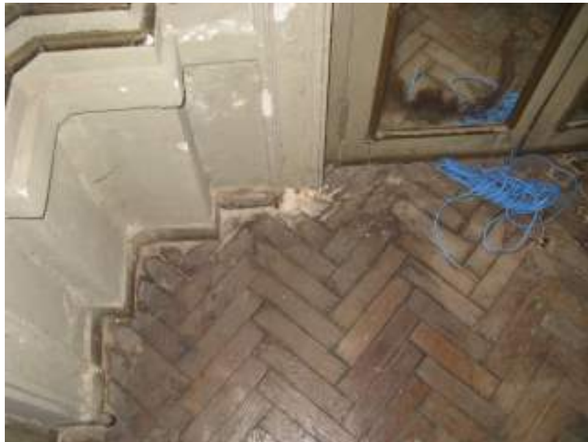
6-PA-MANCHAS DE HUMEDAD-PUTREFACCION-ZOCALOS FALTANTES
