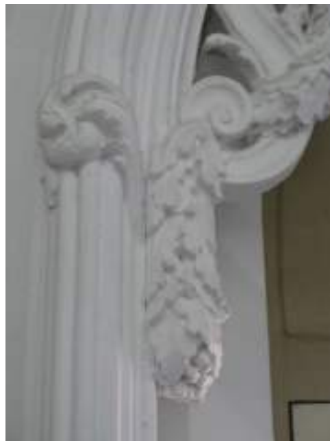
37-FISURAS-PERDIDA DE RELIEVE
