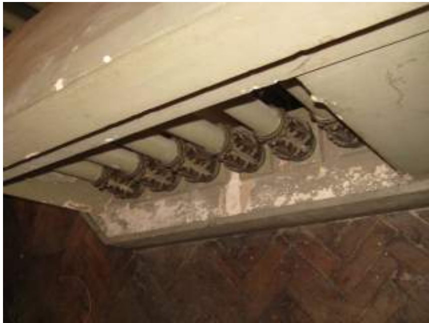
61-CAPA PICTORICA DISGREGADA-INTERVENCION PRECEDENTE
