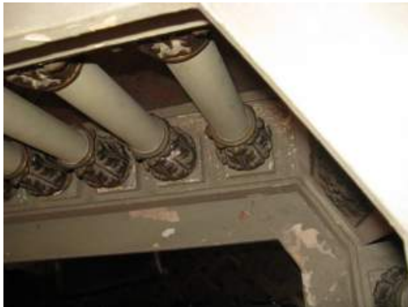
38-CAPA PICTORICA DISGREGADA
