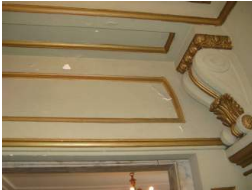
37-DESPRENDIMIENTO DE CAPA PICTORICA
