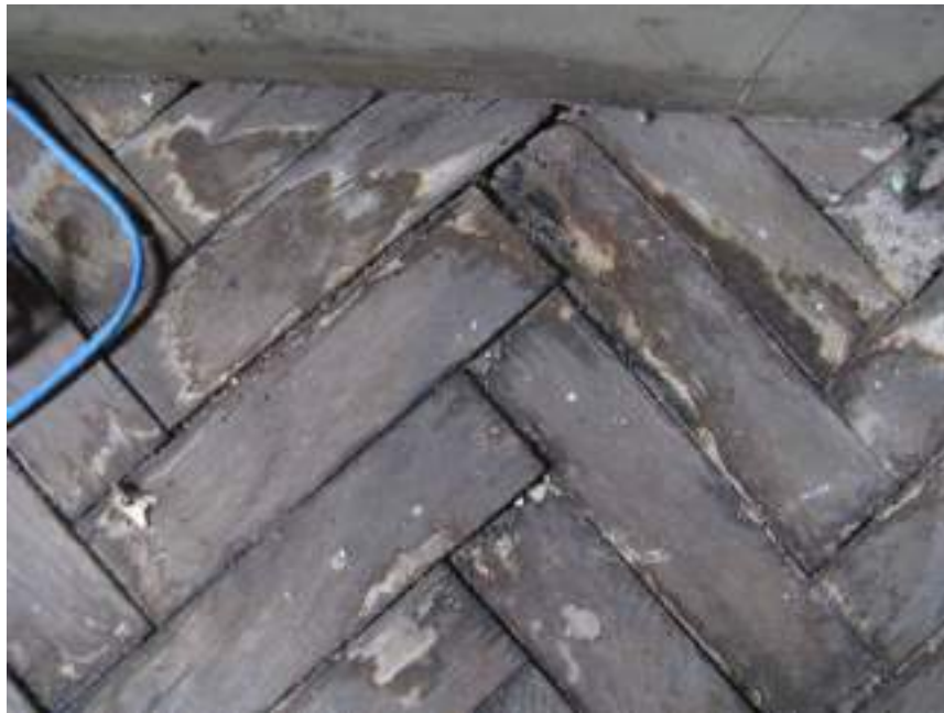
9-PA-DESNIVEL-MANCHAS DE HUMEDAD-PUTREFACCION
