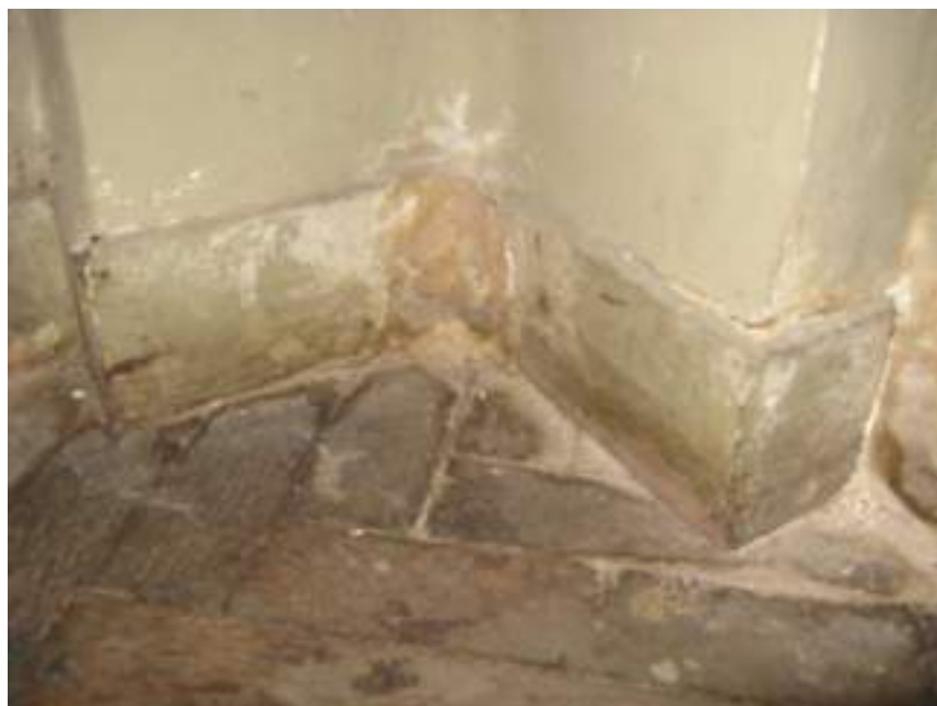
30-MANCHAS DE HUMEDAD-MATERIAL DISGREGADO
