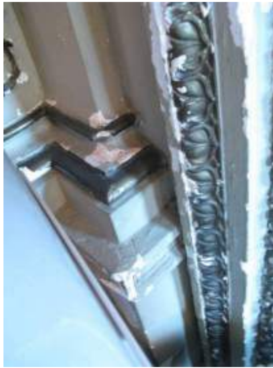
67-FALTANTE PARCIAL-INTERVENCION PRECEDENTE-PERDIDA DE RELIEVE
