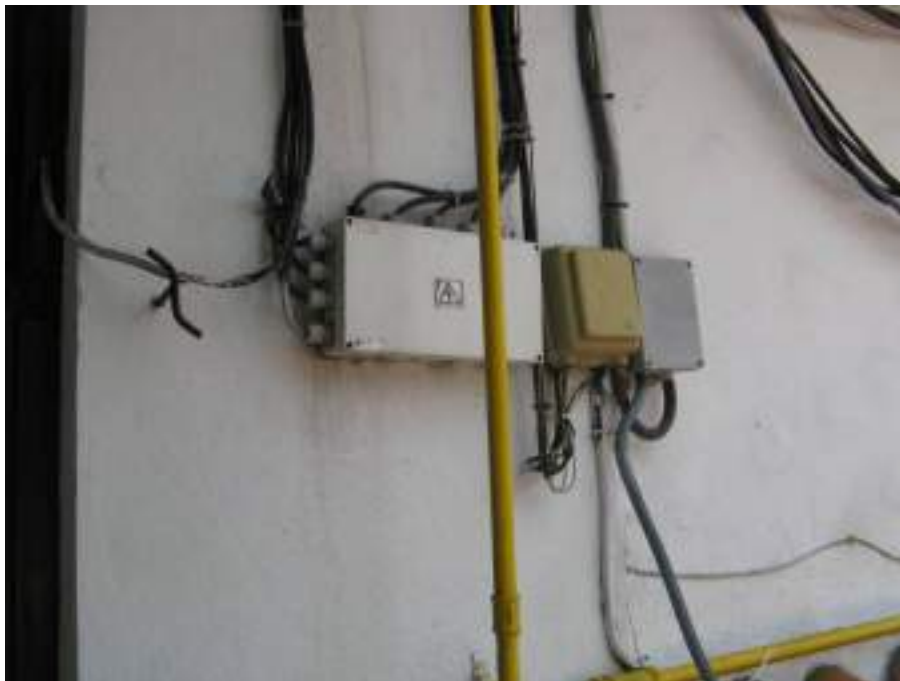
20-INSTALACION NO ORIGINAL-PERFORACIONES
