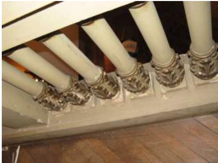
76-CAPA PICTORICA DISGREGADA-MANCHAS DE PINTURA
