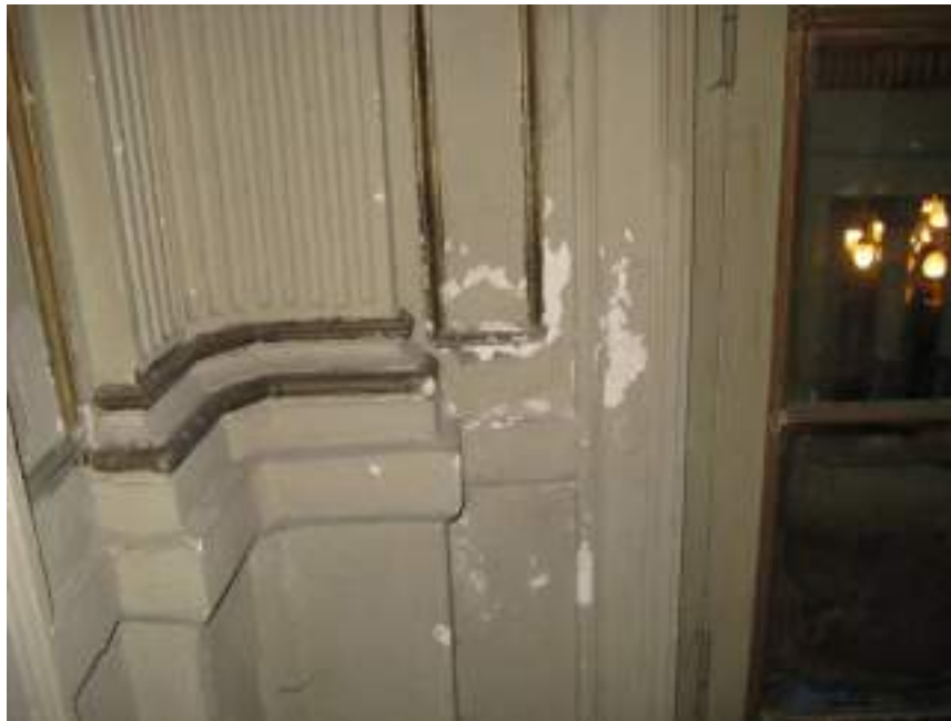
63-DESPRENDIMIENTO DE LA CAPA PICTORICA-PERDIDA DE RELIEVE
