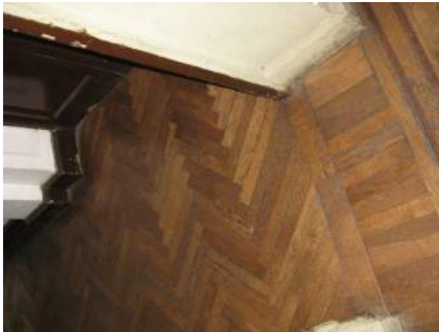
45-PI-JUNTAS ABIERTAS-SUCIEDAD SUPERFICIAL
