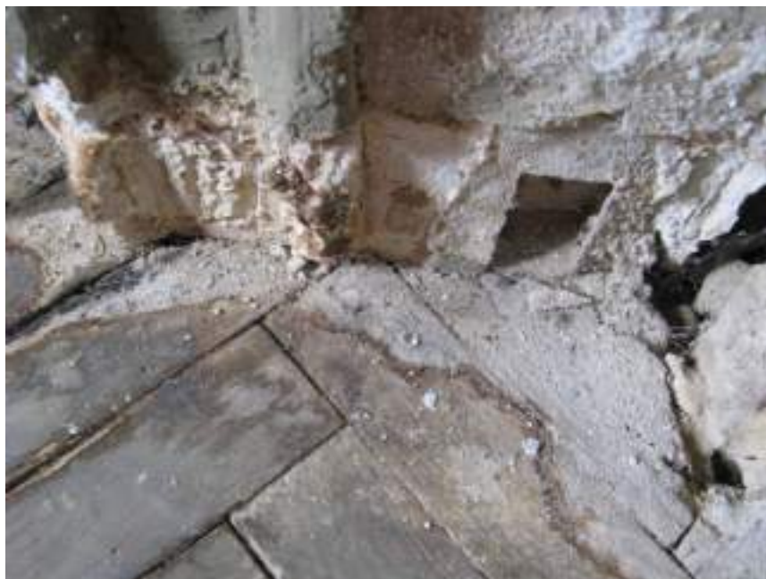
10-MANCHAS DE HUMEDAD-PUTREFACCION
