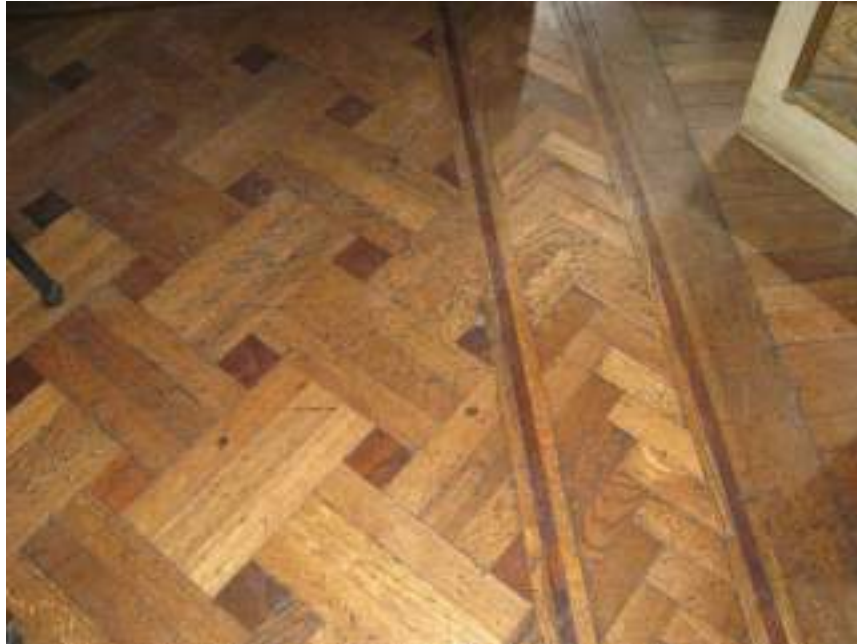
14-JUNTAS ABIERTAS-SUCIEDAD SUPERFICIAL-RAYADURAS
