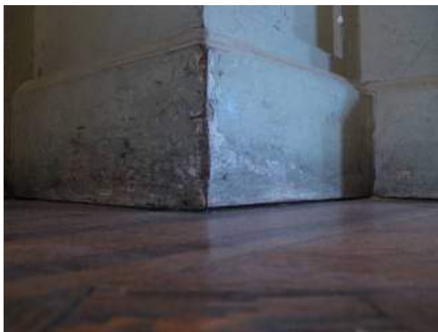
29-PERDIDA DE RELIEVE -RAYADURA
