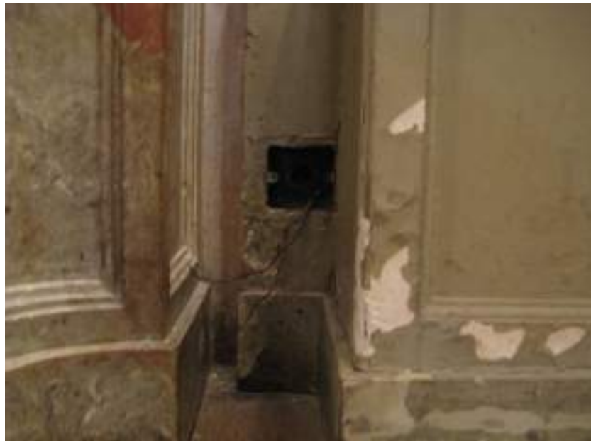
20-INSTALACION OBSOLETA-DESPRENDIMIENTO DE CAPA PICTORICA
