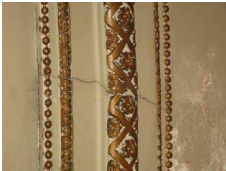
6-FISURAS-CAPA PICTORICA DISGREGADA
