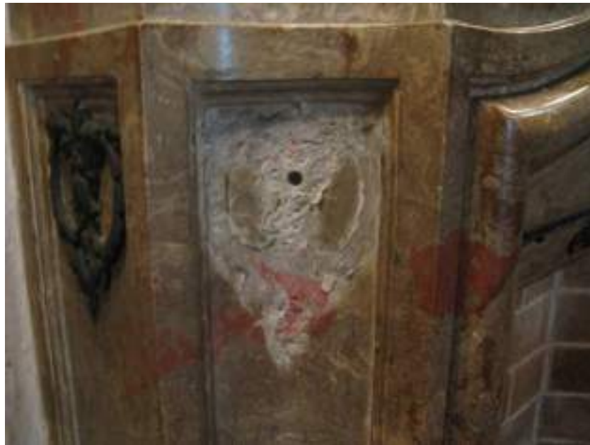
25-FALTANTE TOTAL-SUCIEDAD SUPERFICIAL
