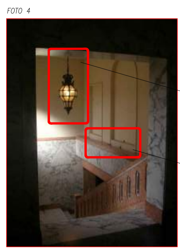
ARAÑA EXISTENTE A RESTAURAR Y A REEMPLAZAR 1 LAMPARA EXISTENTE POR LAMPARAS DE LED TIPO MASTERLED A60 12W INSTALACION EXISTENTE A RESTAURAR Y A REEMPLAZAR LAMPARAS EXISTENTE POR LAMPARAS DE LED
