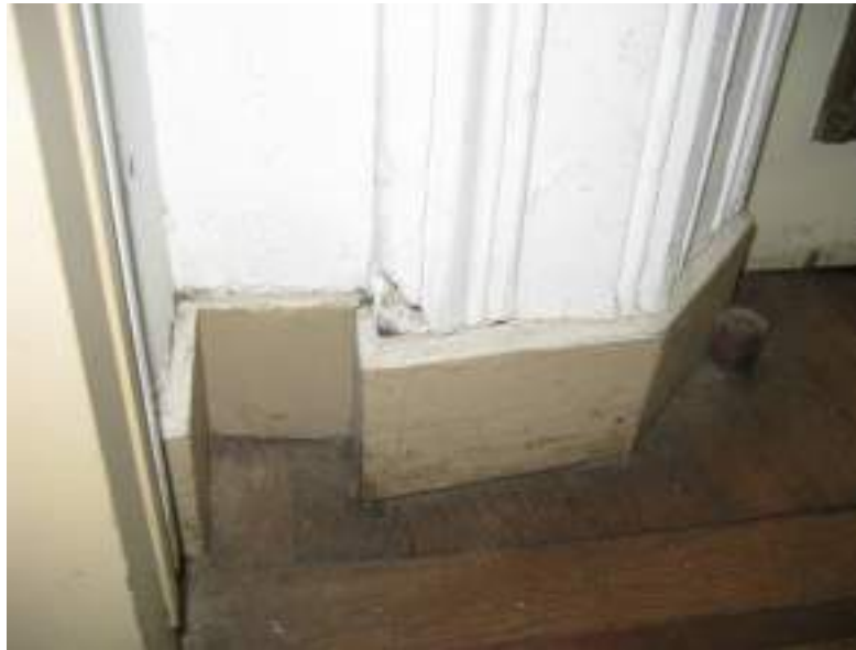
22-FALTANTE PARCIAL-PERDIDA DE RELIEVE
