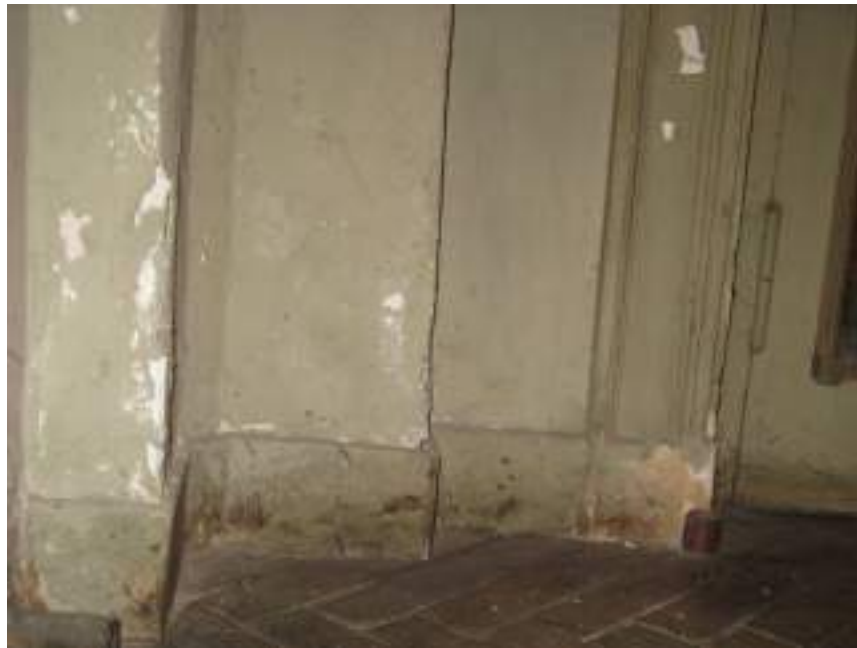
82-FALTANTE PARCIAL-PERDIDA DEL RELIEVE
