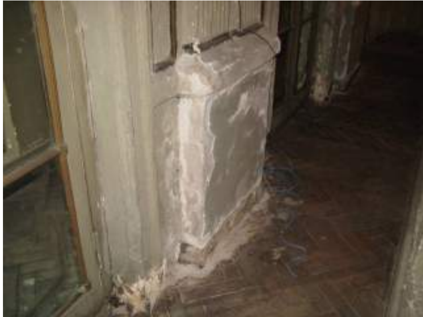
58-INSTALACION OBSOLETA-MATERIAL DISGREGADO-EFLOESCENCIA DE SALES SOLUBLES
