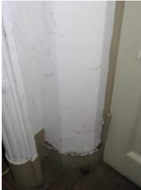
48-INSTALACION OBSOLETA-PERDIDA DE RELIEVE
