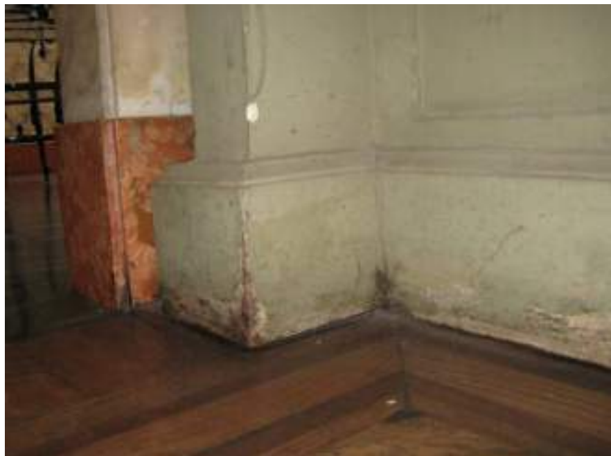
38-PERDIDA DE RELIEVE-RAYADURA
