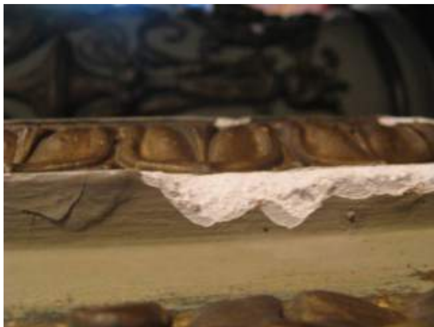
48-FALTANTE PARCIAL-PERDIDA DE RELIEVE
