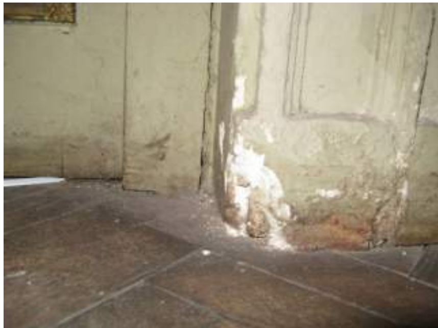
10-MATERIAL DISGREGADO-PERDIDA DE RELIEVE
