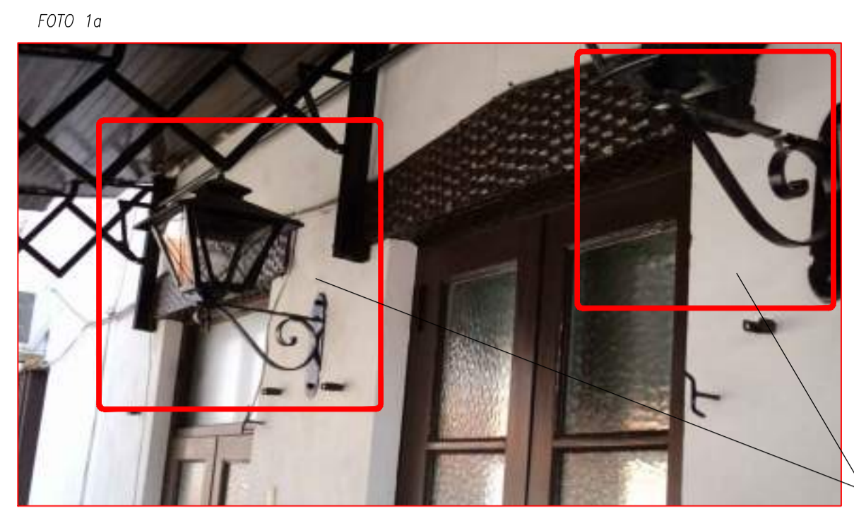
BOCAS DE ILUMINACION Y ENCENDIDOS EXISTENTES A REACONDICIONAR Y A UNIR A CIRCUITO DE OFFICE
