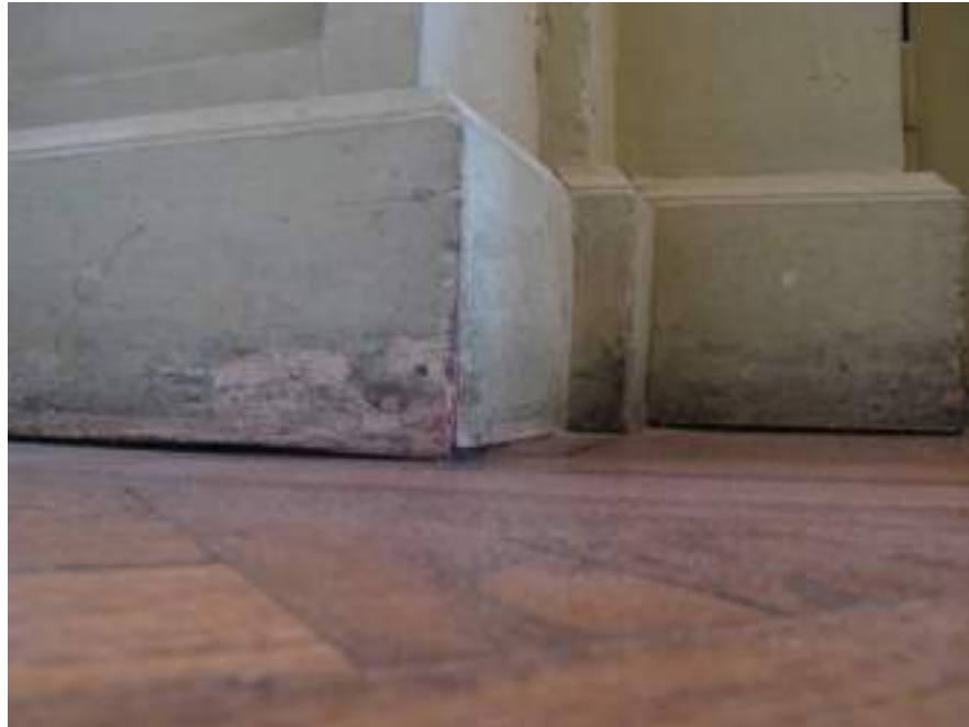
11-PERDIDA DE RELIEVE-RAYADURA
