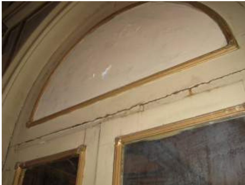
41-MANCHAS DE HUMEDAD-JUNTA ABIERTA EN CARPINTERIA-VIDRIO PINTADO
