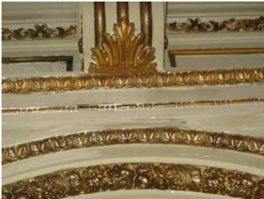
2-INSTALACION NO ORIGINAL-INTERVENCION PRECEDENTE
