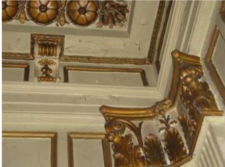
29-DESPRENDIMIENTO DE CAPA PICTORICA-FISURAS
