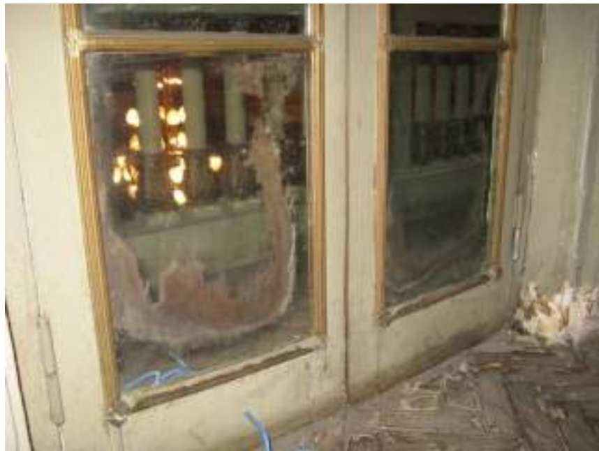
60-ALTERACION DEL PLATEADO-MATERIAL DISGREGADO-PUTREFACCION
