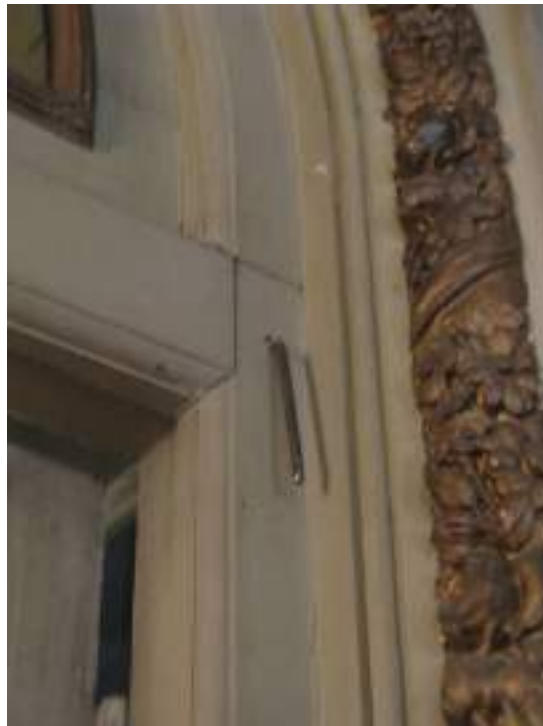
15-INTERVENCION PRECEDENTE-JUNTA ABIERTA DE CARPINTERIA
