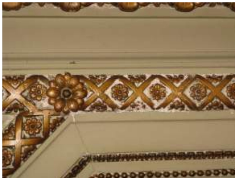
12-EFLORESCENCIA DE SALES SOLUBLES-FISURAS-MATERIAL DISGREGADO
