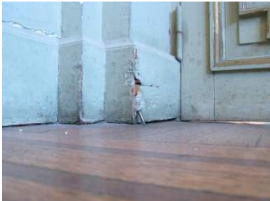
4-FISURAS-PERDIDA DE RELIEVE-RAUADURA
