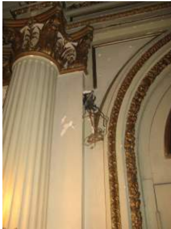
59-DESPRENDIMIENTO DE CAPA PICTORICA-INSTALACION OBSOLETA
