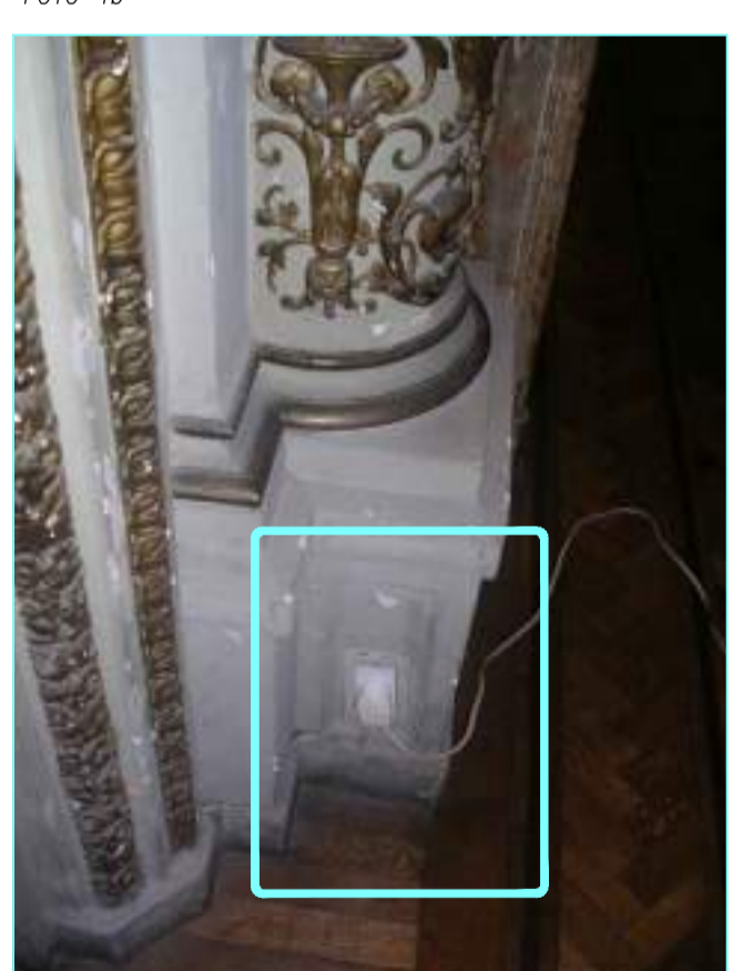
TOMAS EXISTENTES A REEMPLAZAR LAS QUE ESTEN EN MAL ESTADO Y REACONDICIONAR. AGREGAR LA ALIMENTACION EN EL TABLERO SECCIONAL OFFICE
