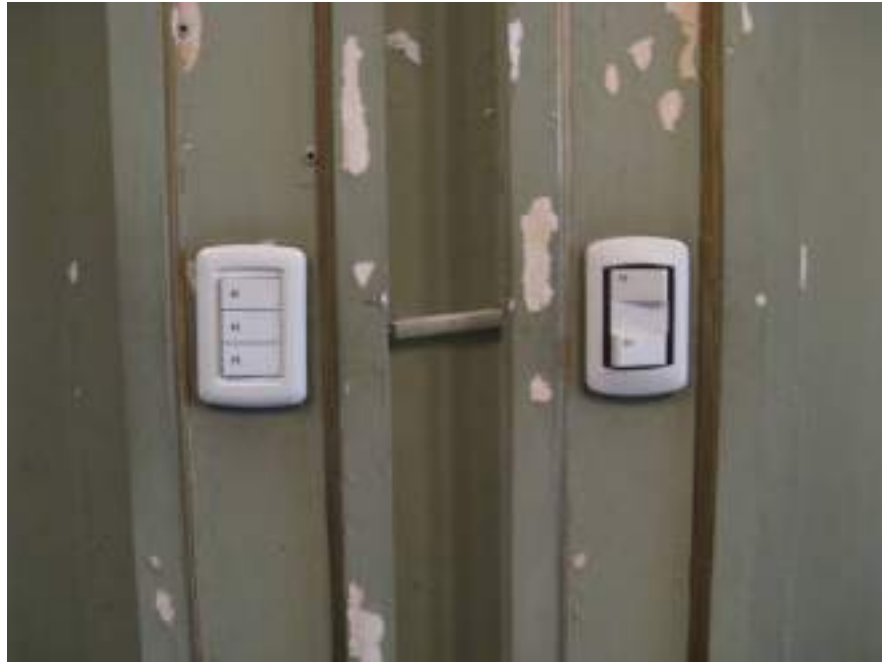
9-DESPRENDIMIENTO DE CAPA PICTORICA-INSTALACION NO ORIGINAL
