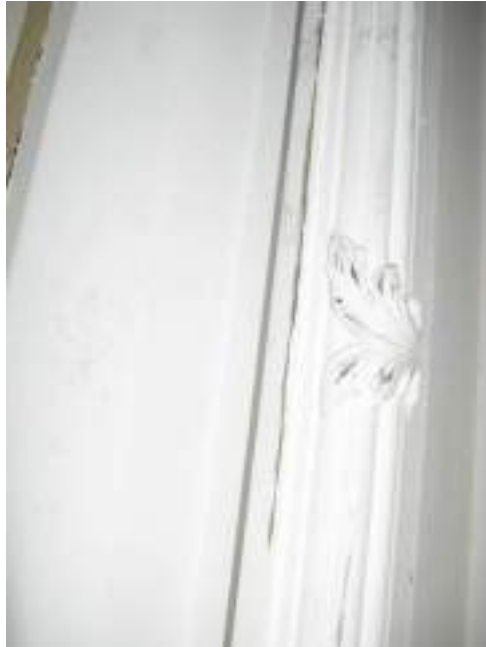
56-PERDIDA DE RELIEVE-RAYADURAS
