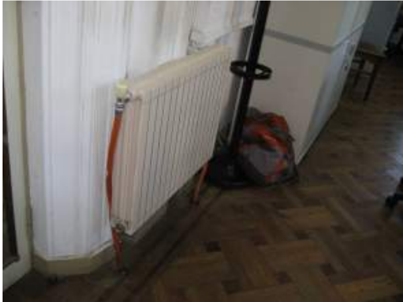
18-INSTALACION NO ORIGINAL-PEFORACIONES
