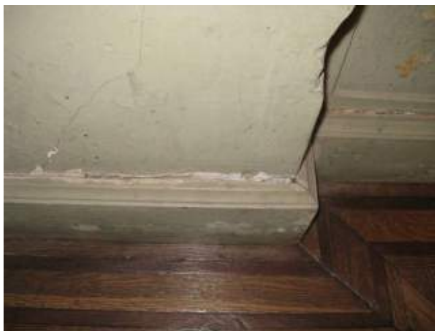
35-FALTANTE PARCIAL-FISURAS-ZOCALOS DESPRENDIDOS
