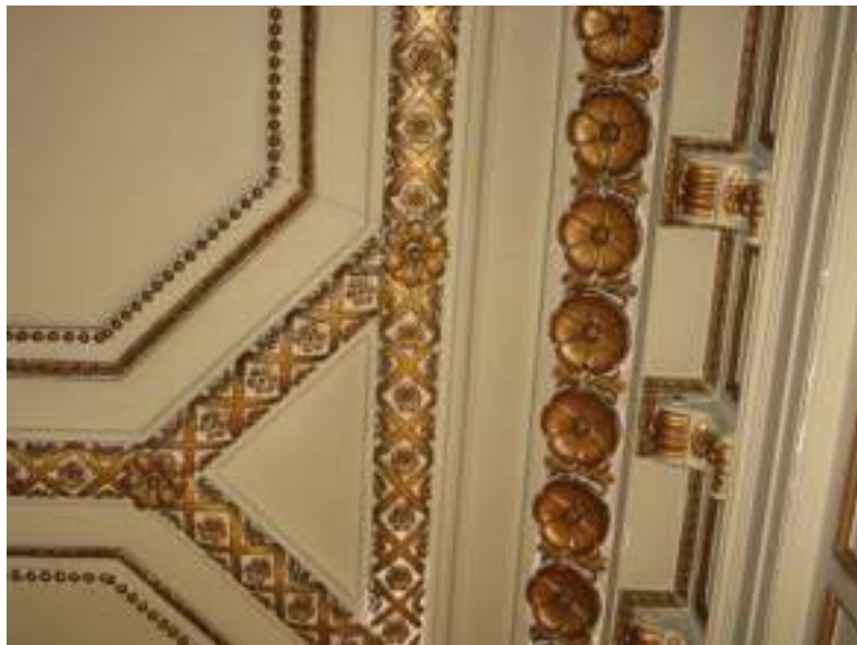
11-EFLORESCENCIA DE SALES SOLUBLES-FISURAS
