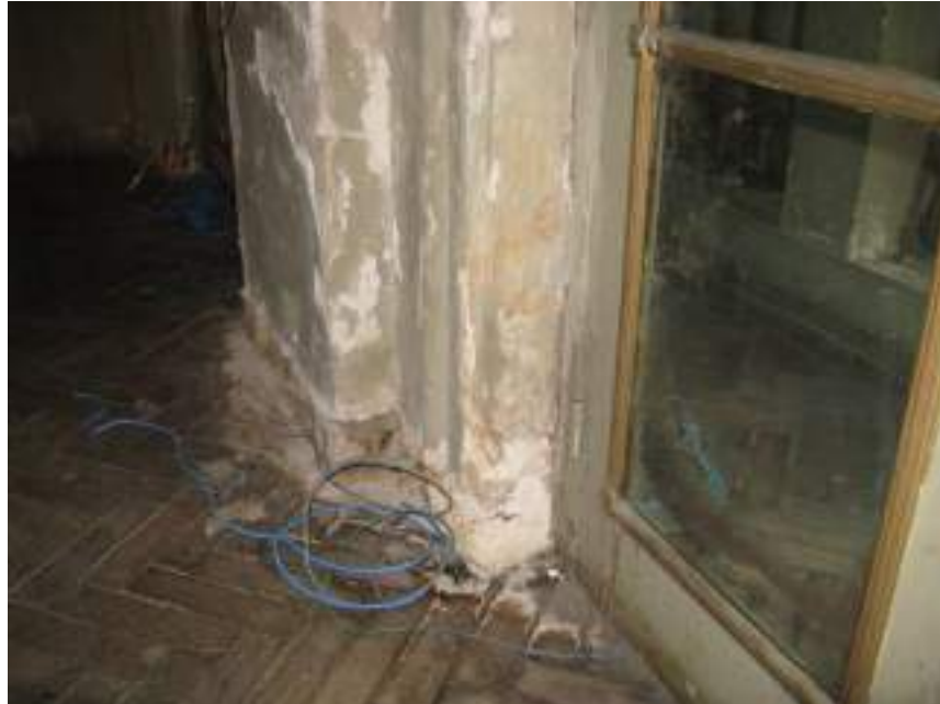
54-INSTALACION OBSOLETA-MATERIAL DISGREGADO-SALES SOLUBLES EN SUPERFICIE
