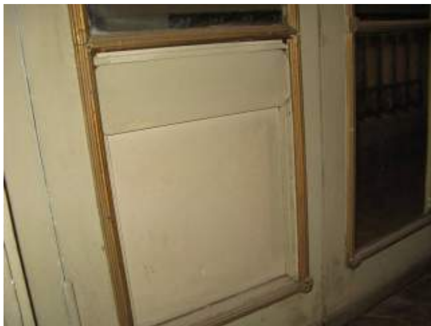
36-FALTANTE TOTAL-VIDRIO FALTANTE
