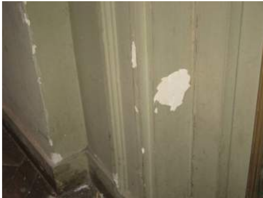
11-FISURAS-DESPRENDIMIENTO DE CAPA PICTORICA-FISURAS-MICROORGANISMOS
