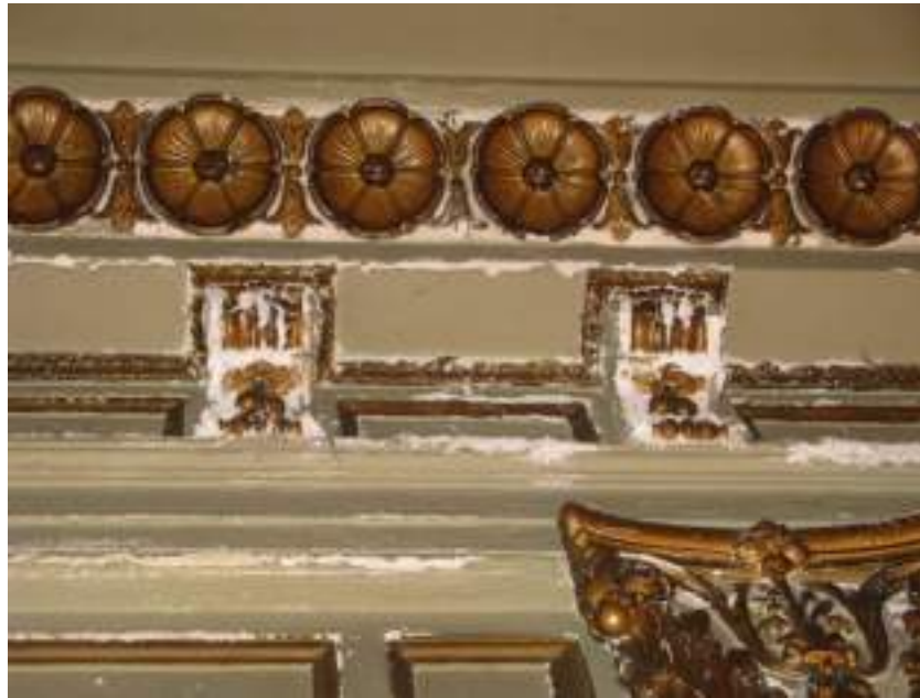
20- EFLORESCENCIAS DE SALES SOLUBLES-MATERIAL DISGREGADO
