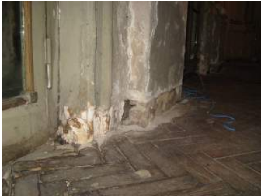
59-MANCHAS DE HUEMDAD-MATERIAL DISGREGADO-EFLORESCENCIA DE SALES SOLUBLES
