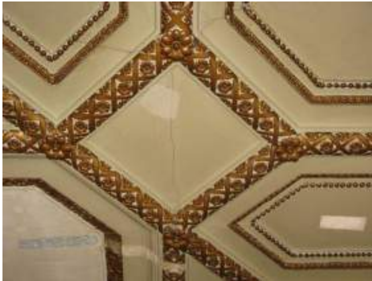
3-FISURAS-INTERVENCIÓN PRECEDENTE-MANCHAS DE HUMEDAD
