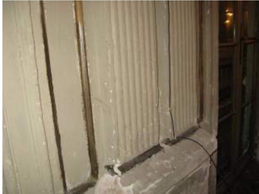
56-INSTALACION ERRONEA-MATERIAL DISGREGADO
