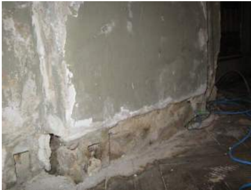
57-ZOCALO FALTANTE-MATERIAL DISGREGADO
