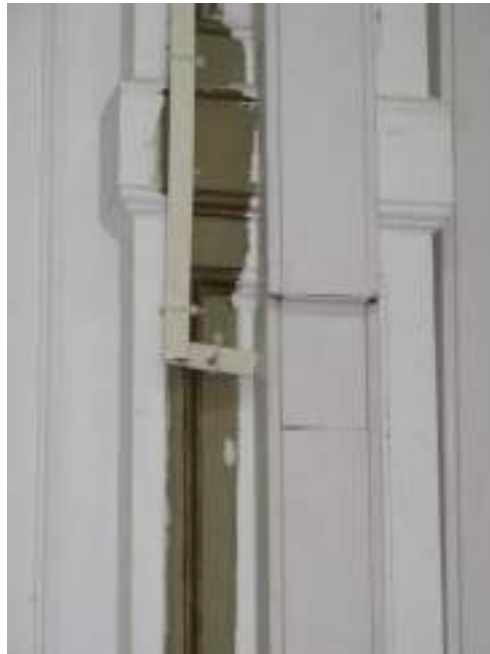
38-INSTALACION NO ORIGINAL-INTERVENCION PRECEDENTE
