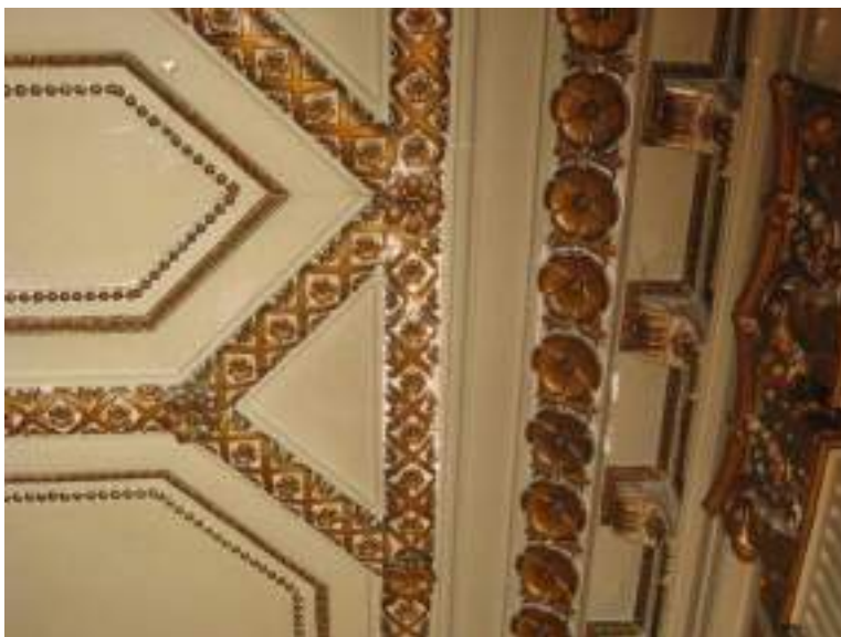
10-EFLORESCENCIA DE SALES SOLUBLES-FISURAS-MATERIAL DISGREGADO
