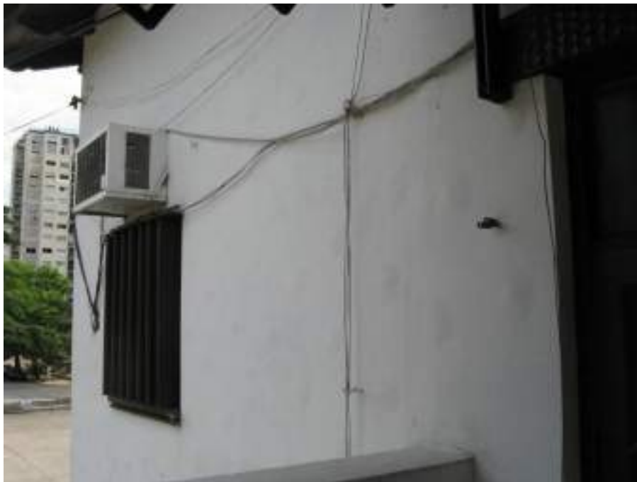
24-INSTALACION NO ORIGINAL-PERFORACIONES
