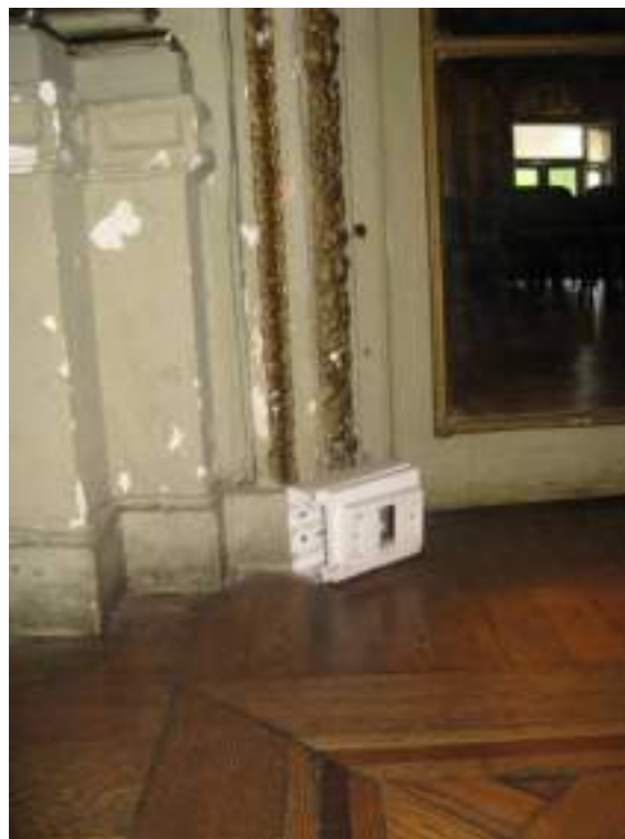
28-INSTALACION OBSOLETA-PERDIDA DE RELIEVE-PERFORACION
