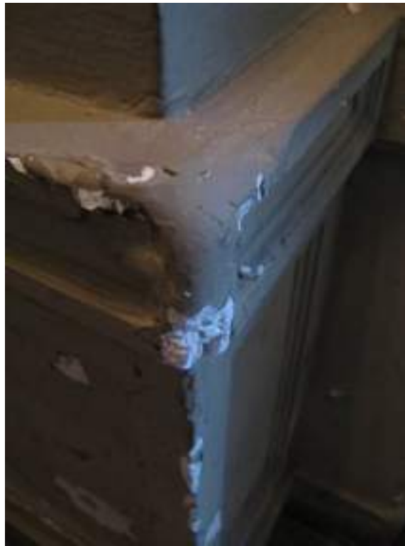
65-FALTANTE PARCIAL-INTERVENCION PRECEDENTE-PERDIDA DE RELIEVE
