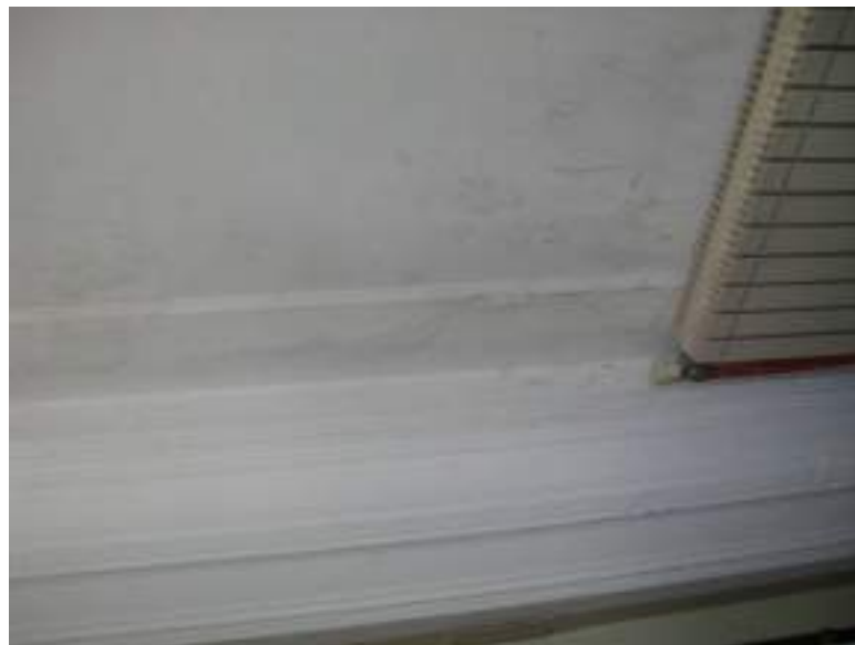
35-INSTALACION NO ORIGINAL-MANCHAS DE HUENDAD-PERDIDA DE RELIEVE
