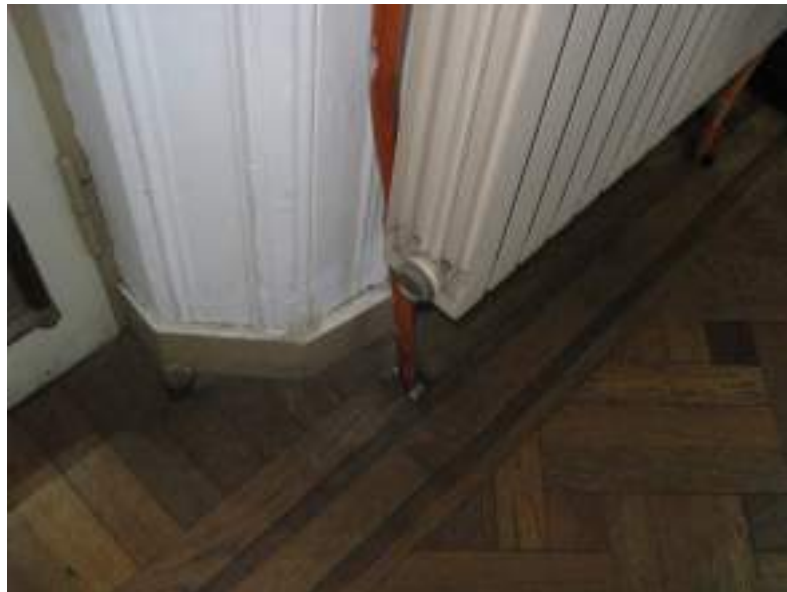
19-INSTALACION NO ORIGINAL-PERDIDA DE RELIEVE-PERFORACIONES
