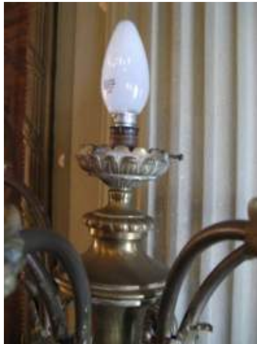
35-FALTANTE DE PORTALAMPARA-MANCHAS DE OXIDO
