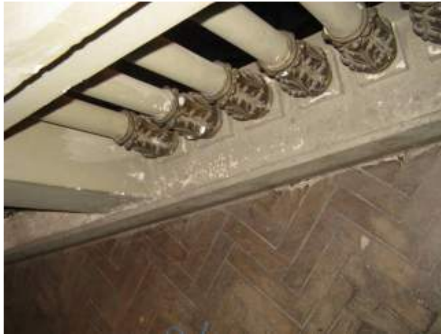
53-CAPA PICTORICA DISGREGADA-MANCHAS DE HUMEDAD
