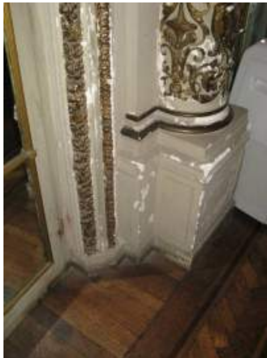
68-DESPRENDIMIENTO DE CAPA PICTORICA
