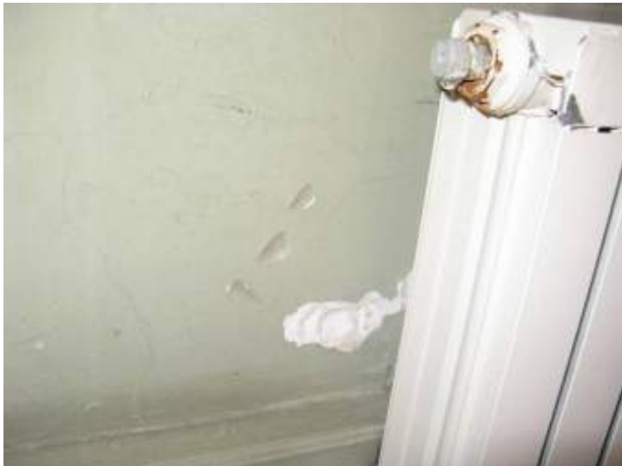
19-INSTALACION NO ORIGINAL-FALTANTES PARCIALES-FISURAS
