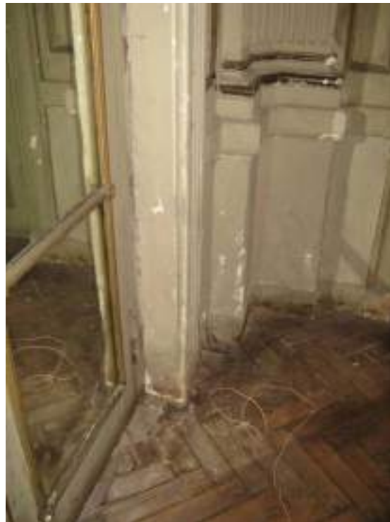
48-MANCHAS DE HUMEDAD-MATERIAL DISGREGADO
