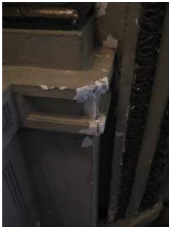
64-FALTANTE PARCIAL-PERDIDA DE RELIEVE
