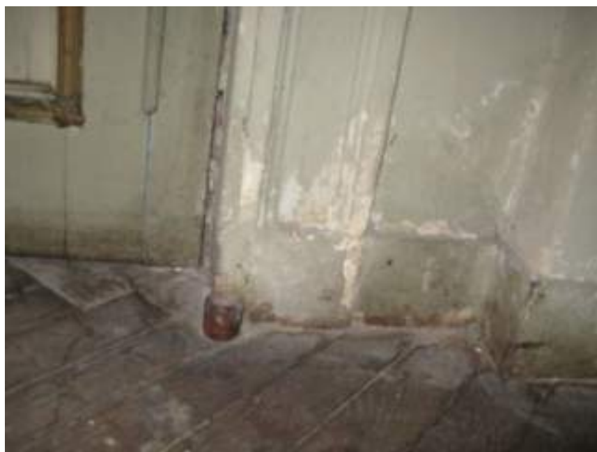
31-MANCHAS DE HUEMDAD-MATERIAL DISGREGADO
