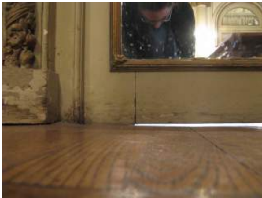
49-JUNTA ABIERTA DE CARPINTERIA-FALTANTE PARCIAL-RAYADURA
