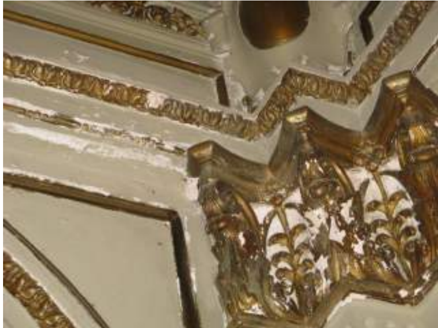
82-EFLORESCENCIA DE SALES SOLUBLES-FALTANTE PARCIAL-MATERIAL DISGREGADO
