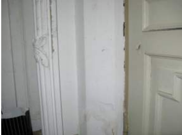
53-MANCHAS DE HUEMDAD-PERDIDA DE RELIEVE
