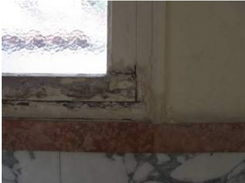
15-MANCHAS DE HUMEDAD-PUTREFACCION
