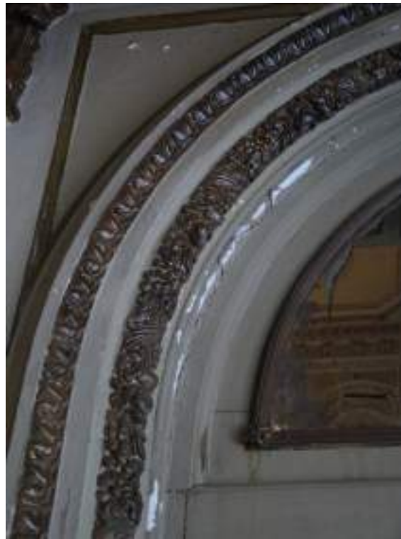
37-ALTERACION DEL PLATEADO-JUNTA ABIERTA EN CARPINTERIA
