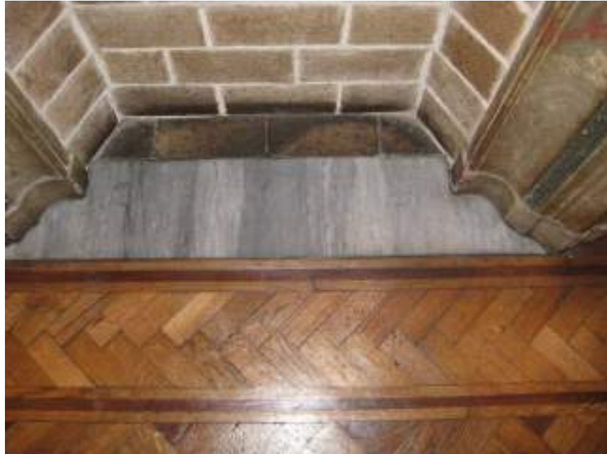
16-JUNTAS ABIERTAS-SUCIEDAD SUPERFICIAL
