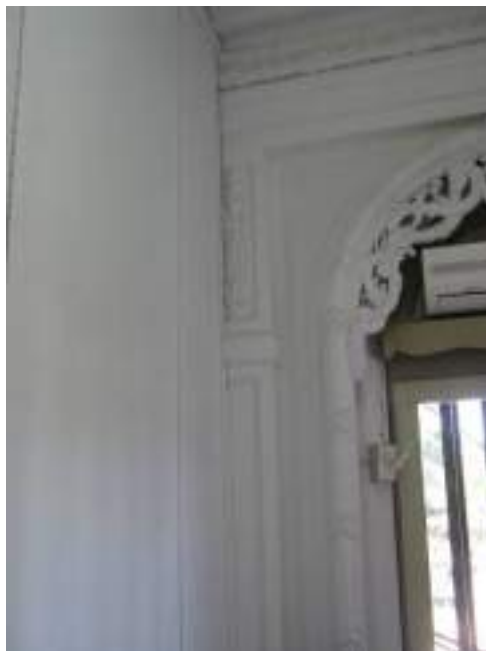
43-INSTALACION NO ORIGINAL-INTERVENCION PRECEDENTE-PERDIDA DE RELIEVE
