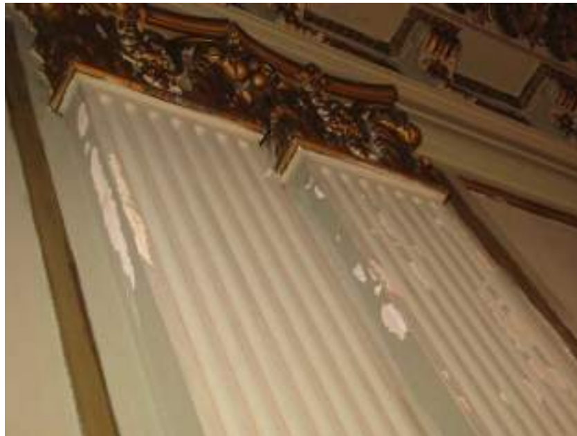
7-DESPRENDIMIENTO DE CAPA PICTORICA
