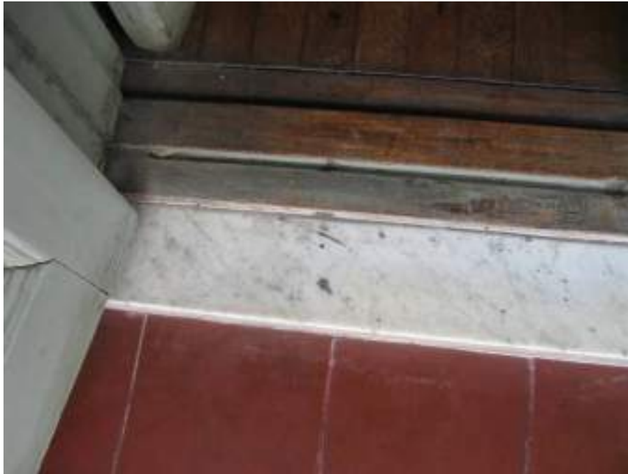
23-JUNTAS ABIERTAS-MANCHAS DE PINTURA
