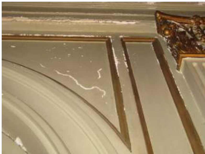
18-EFLORESCENCIAS DE SALES SOLUBLES-MATERIAL DISGREGADO
