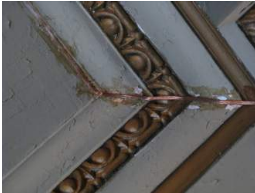
49-INSTALACION NO ORIGINAL-DESPRENDIMIENTO DE CAPA PICTORICA
