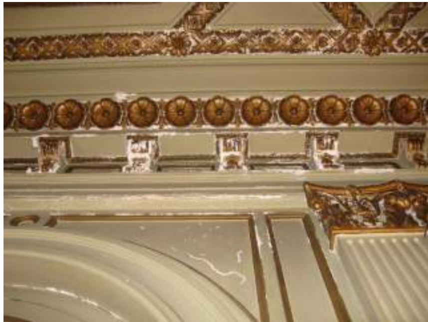
21- EFLORESCENCIAS DE SALES SOLUBLES-MATERIAL DISGREGADO
