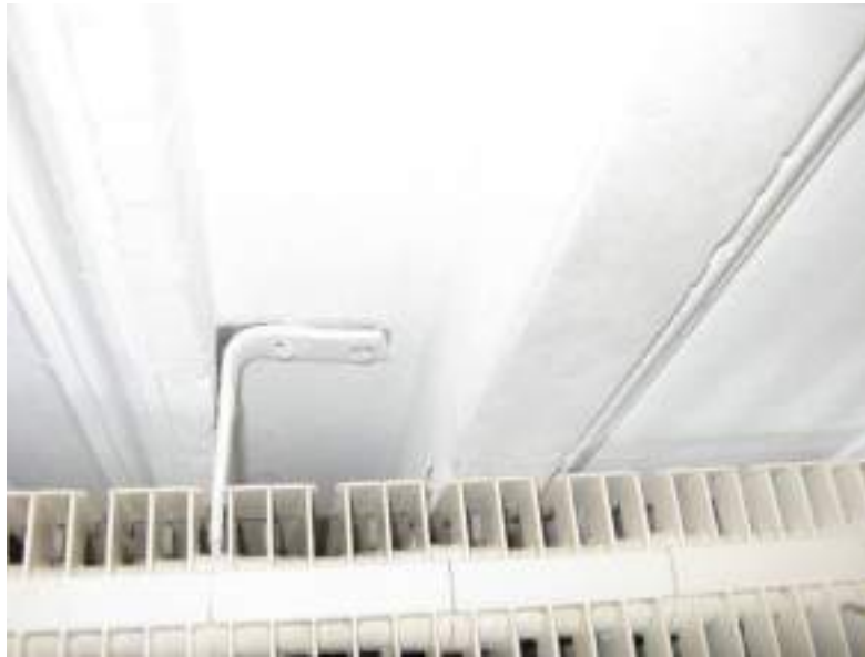
20-INSTALACION NO ORIGINAL-PERDIDA DE RELIEVE-PERFORACIONES
