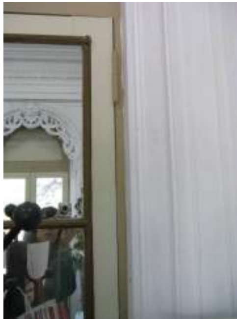
11-FALTANTE PARCIAL-FALTANTE TOTAL
