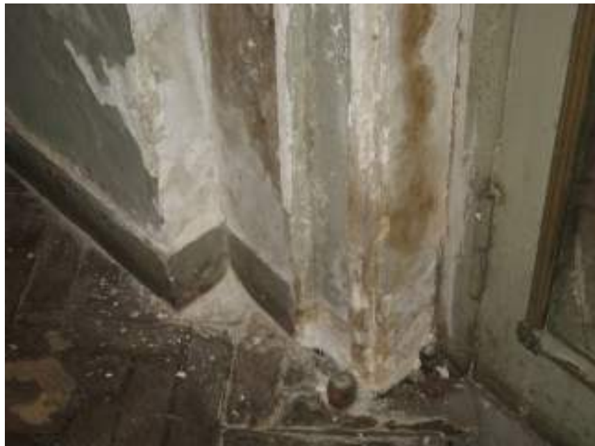
50-MANCHAS DE HUEMDAD-MATERIAL DISGREGADO-SALES SOLUBLES EN SUPERFICIE
