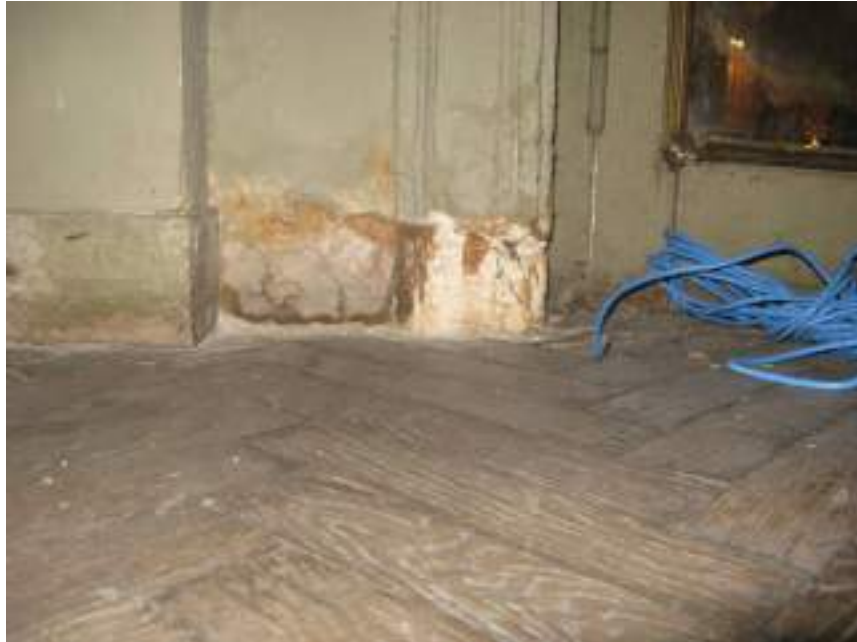
62-ZOCALO FALTANTE-MANCHAS DE HUEMDAD-MATERIAL DISGREGADO
