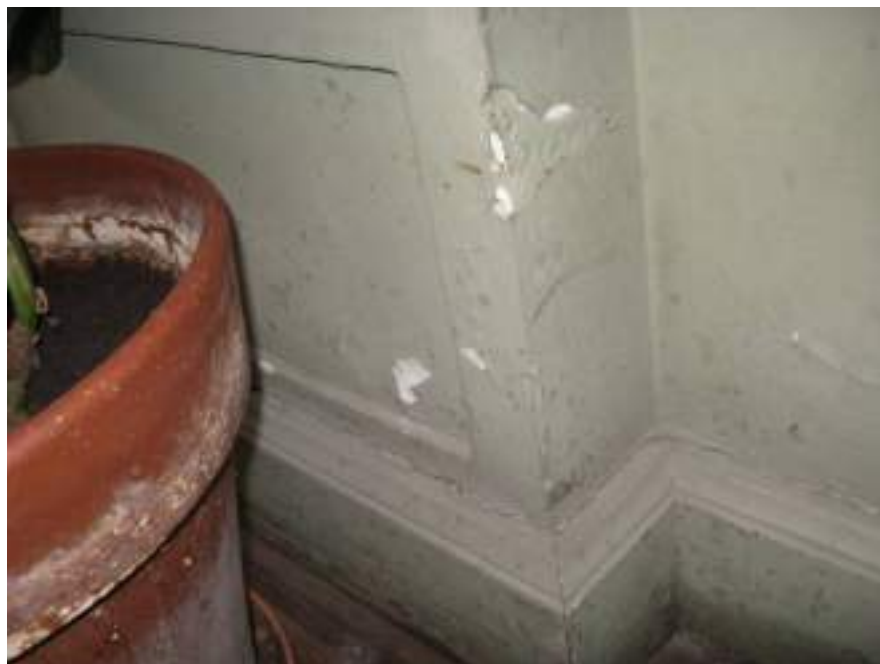
32-FALTANTE PARCIAL-FISURAS-PERDIDA DE RELIEVE
