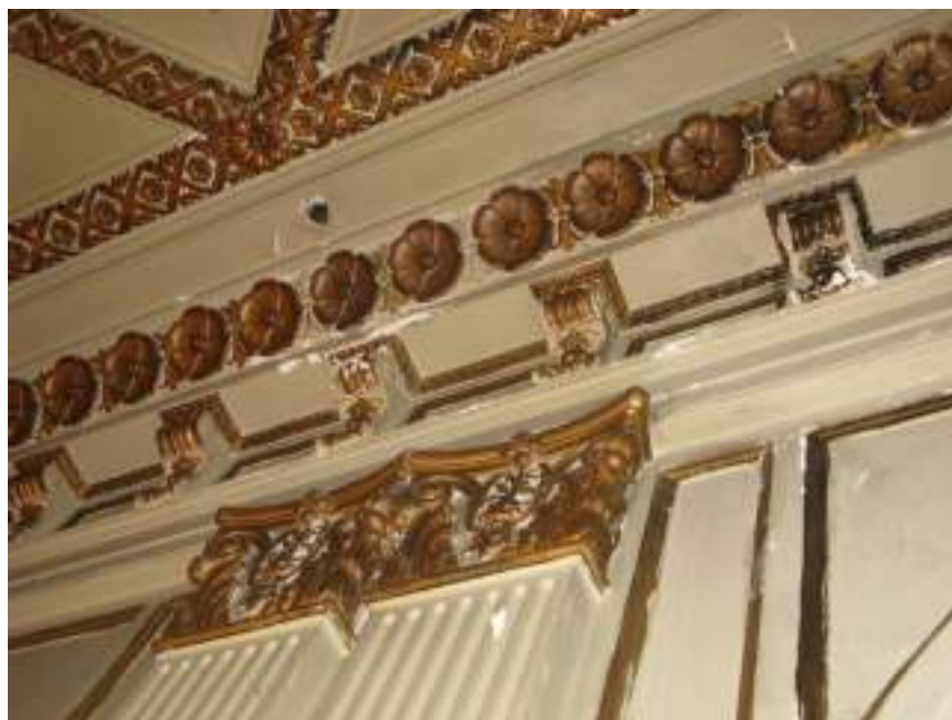
70-EFLORESCENCIA DE SALES SOLUBLES-FALTANTE PARCIAL-MATERIAL DISGREGADO
