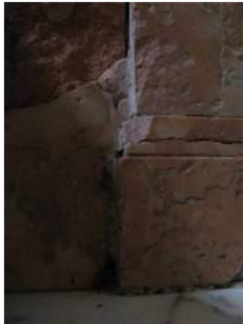
2-FALTANTE PARCIAL – FRACTURA-PERDIDA DE RELIEVE
