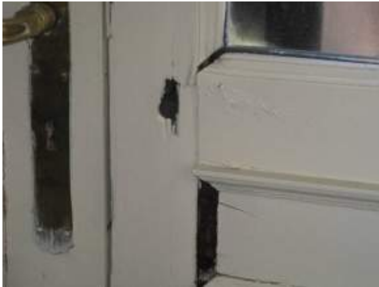
32-INSTALACION NO ORIGINAL-JUNTA ABIERTA EN CARPINTERIA-FALTANTE TOTAL
