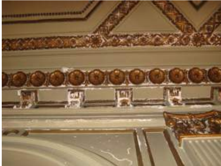
9-EFLORESCENCIA DE SALES SOLUBLES-FISURAS-MATERIAL DISGREGADO
