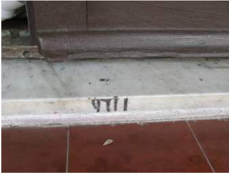
21-MANCHAS DE PINTURA-SUCIEDAD SUPERFICIAL
