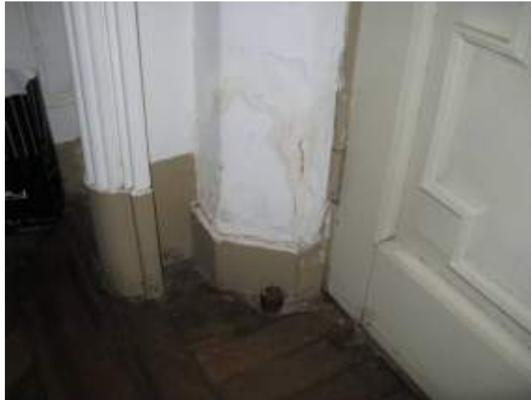
54-DESPRENDIMIENTO CAPA PICTORICA-JUNTA ABIERTA EN CARPINTERIA-MANCHAS
