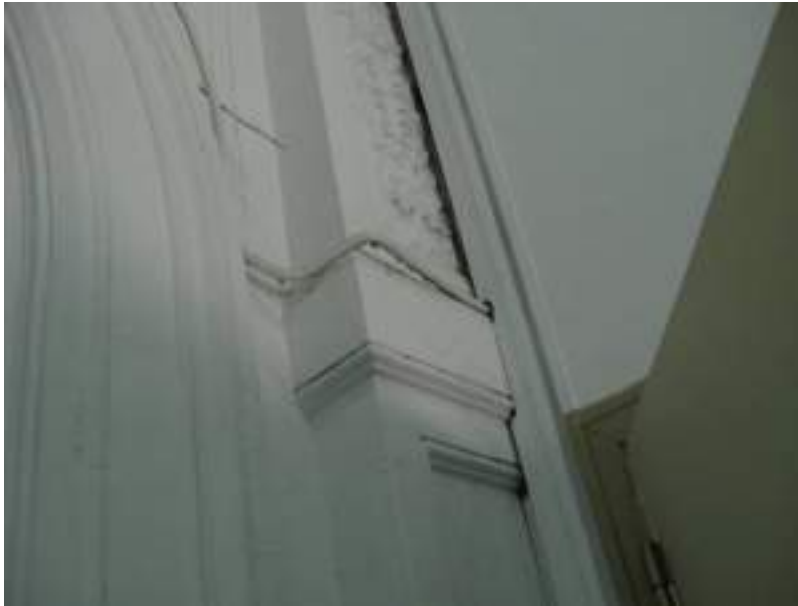
6-INSTALACION NO ORIGINAL-INTERVENCION PRECEDENTE
