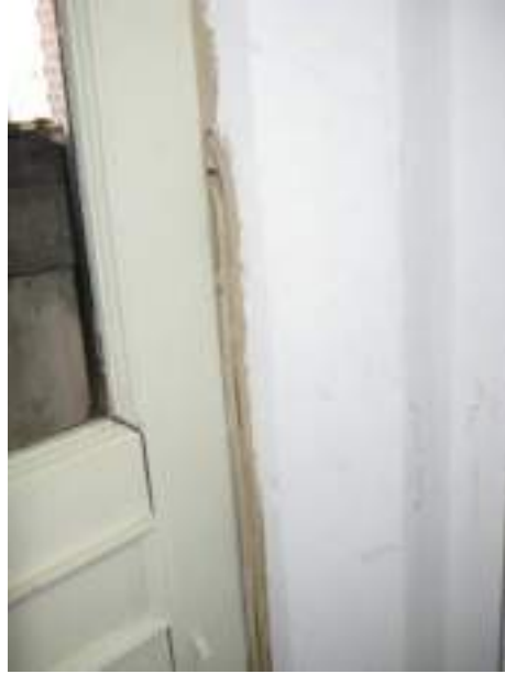
52-JUNTA ABIERTA EN CARPINTERIA-INSTALACION NO ORIGINAL
