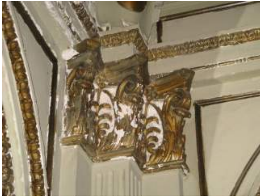
1-EFLORESCENCIA DE SALES-SOLUBLES-MATERIAL DISGREGADO
