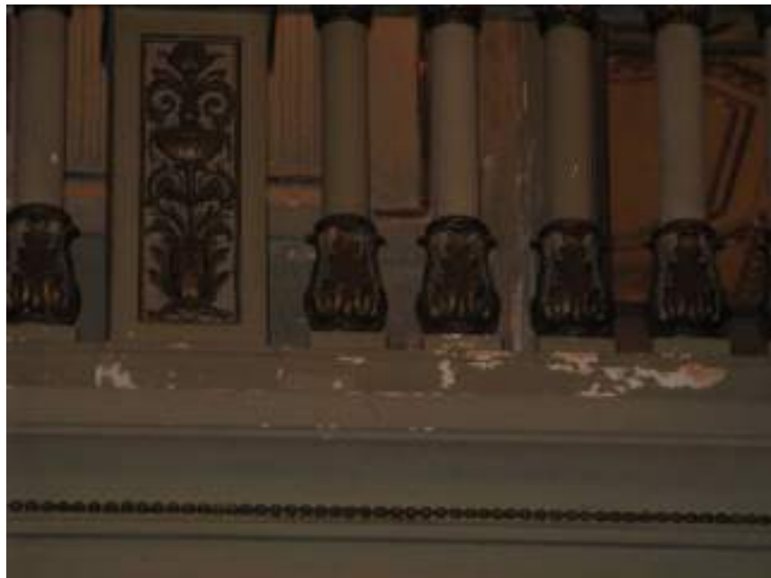
58-DESPRENDIMIENTO DE CAPA PICTORICA
