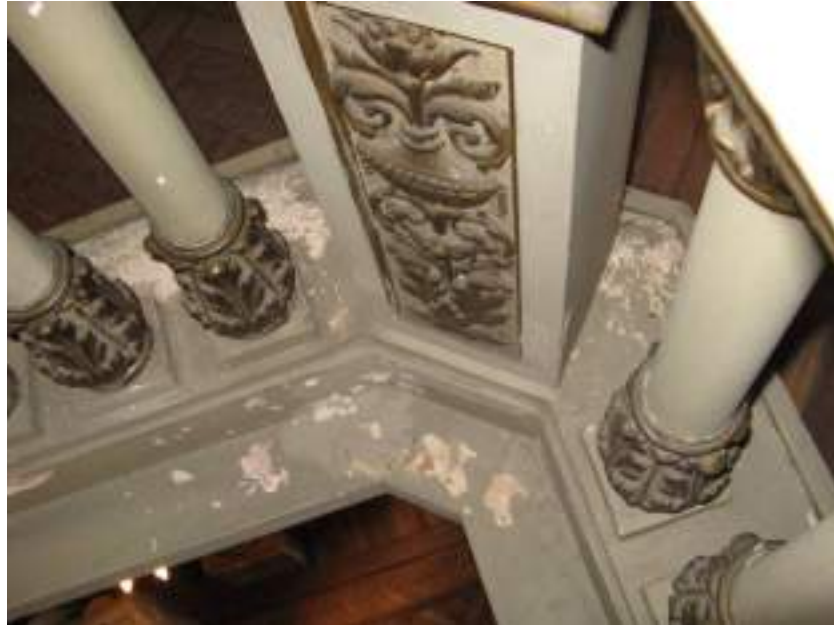
72-CAPA PICTORICA DISGREGADA
