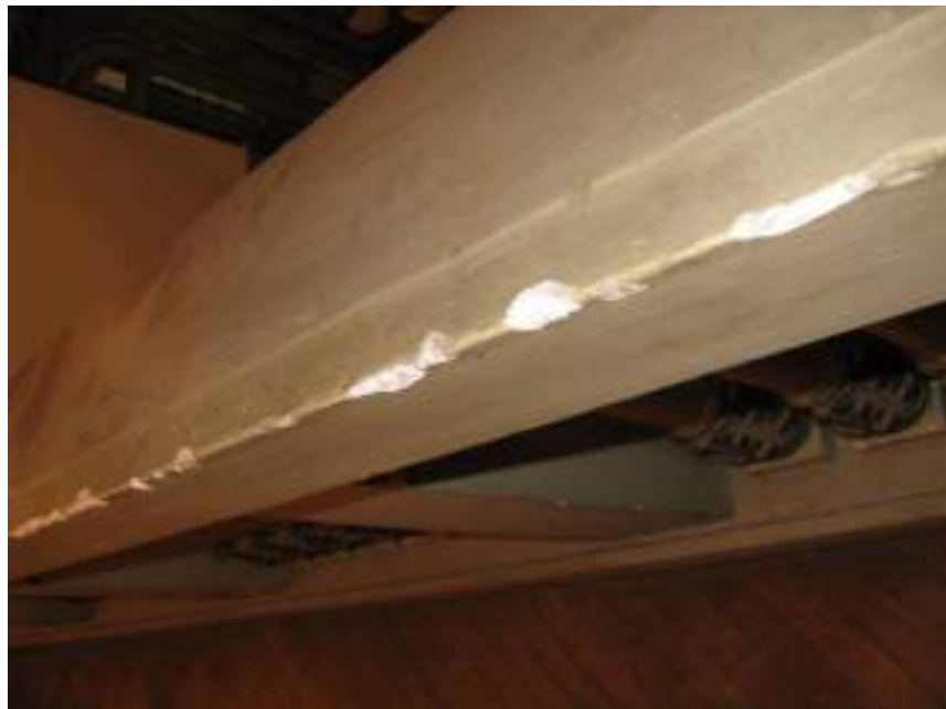
74-FALTANTE PARCIAL-PERDIDA DE RELIEVE
