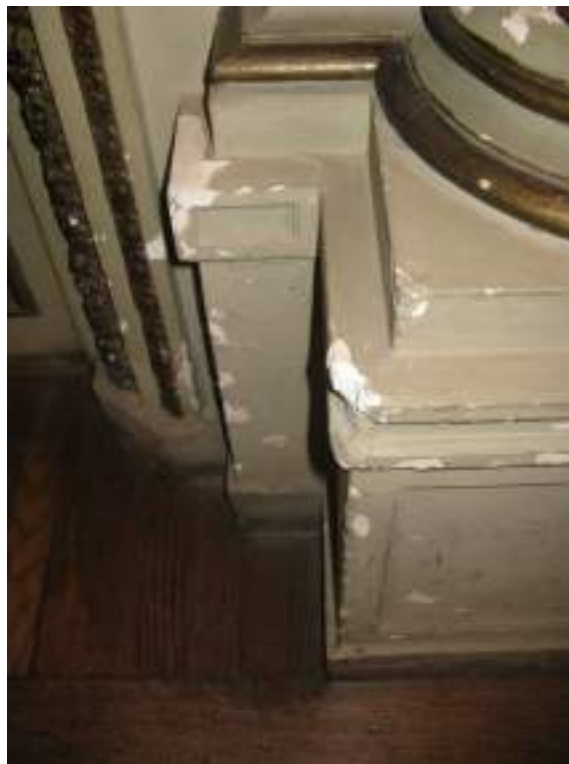
84-FALTANTE PARCIAL-INTERVENCION PRECEDENTE-PERDIDA DE RELIEVE
