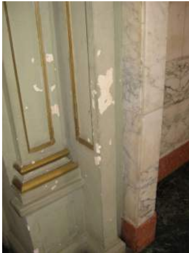
39-DESPRENDIMIENTO DE CAPA PICTORICA
