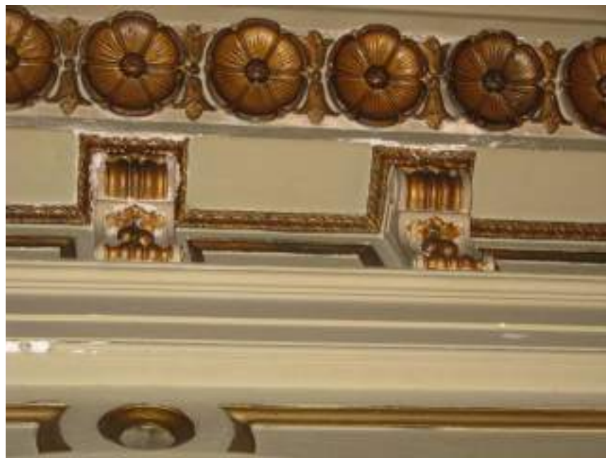
67-MATERIAL DISGREGADO-EFLORESCENCIA DE SALES SOLUBLES
