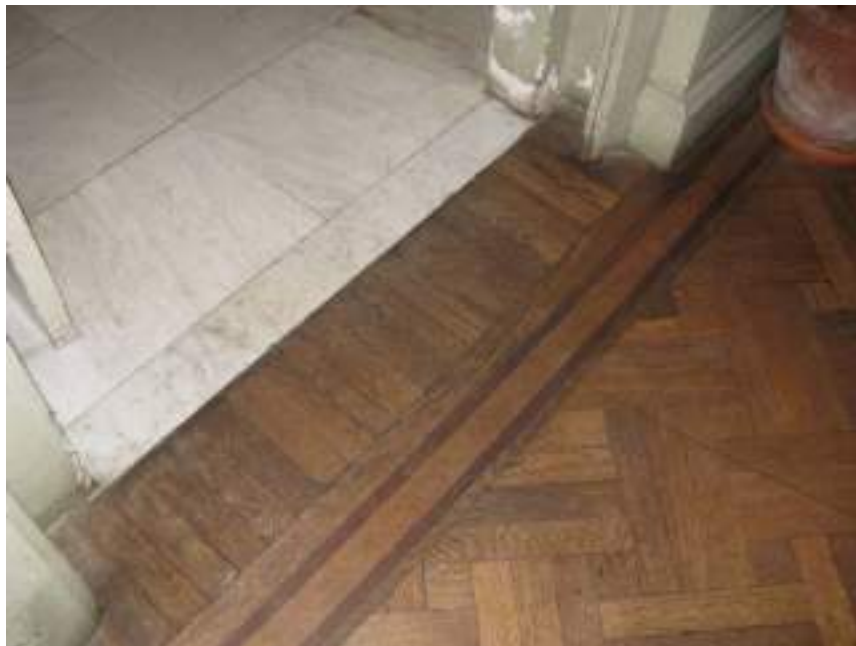
46-PI-JUNTAS ABIERTAS-SUCIEDAD SUPERFICIAL-RAYADURAS
