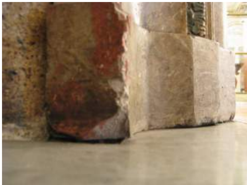
22-FALTANTE PARCIAL-PERDIDA DE RELIEVE-SUCIEDAD SUPERFICIAL
