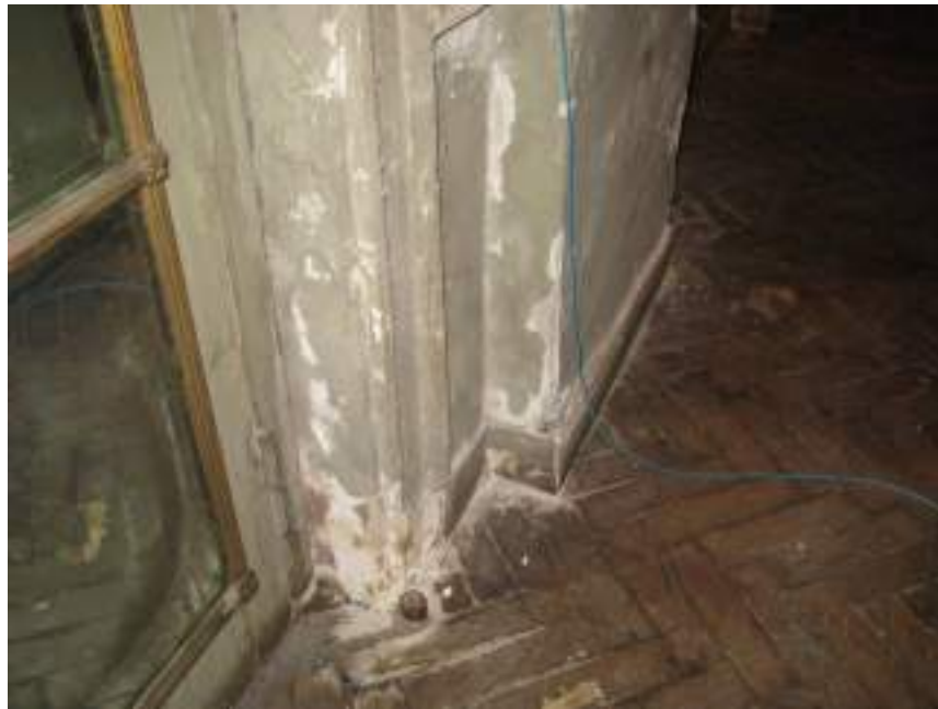
53-MANCHAS DE HUEMEDAD-MATERIAL DISGREGADO
