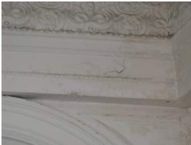
13-CAPA PICTORICA DISGREGADA-PERDIDA DE RELIEVE
