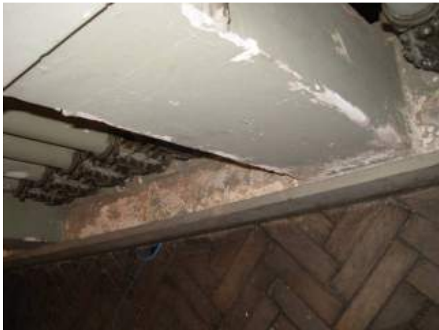
56-CAPA PICTORICA DISGREGADA-PERDIDA DE RELIEVE
