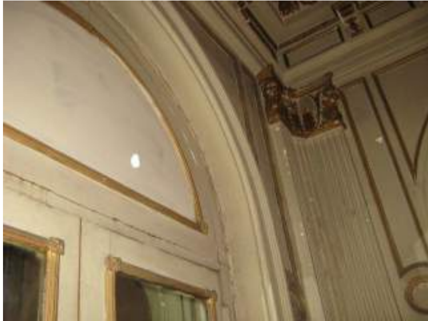
46-MANCHAS DE HUMEDAD-VIDRIO PINTADO
