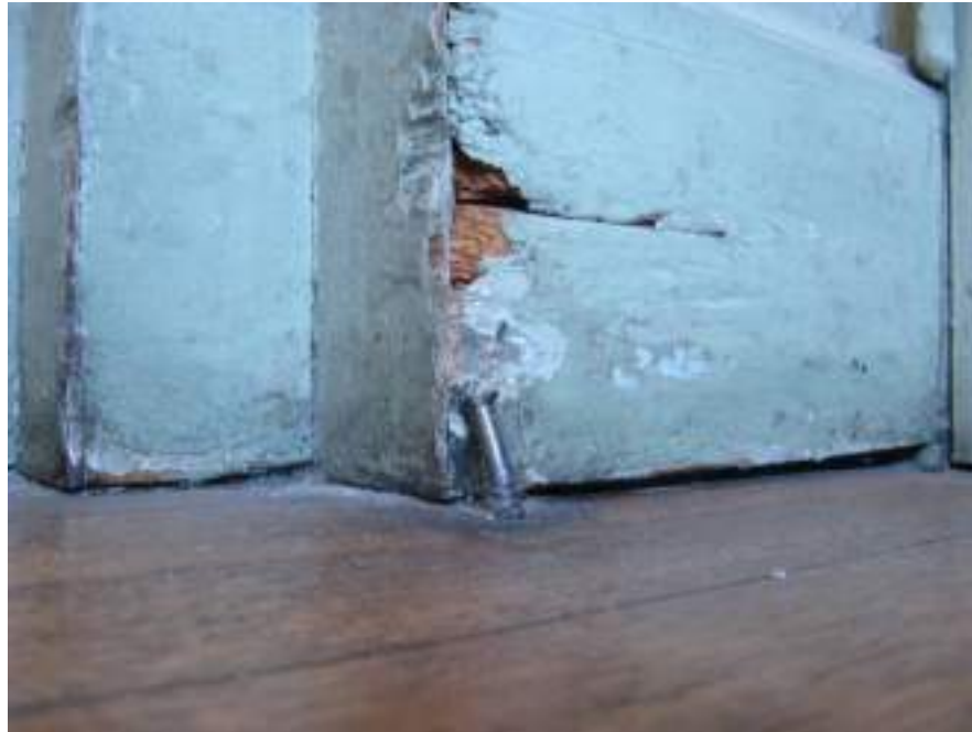
3-FALTANTE PARCIAL-ITERVENCION PRECEDENTE-RAJADURA
