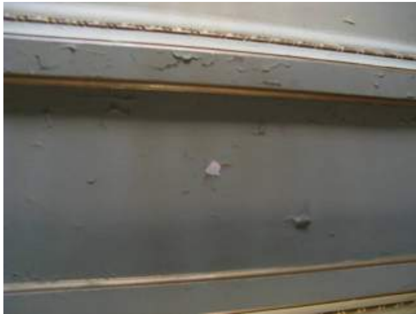
43-DESPRENDIMIENTO DE CAPA PICTORICA
