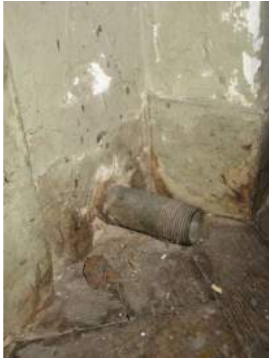
47-INSTALACION OBSOLETA-MATERIAL DISGREGADO-MANCHA DE HUEMDAD
