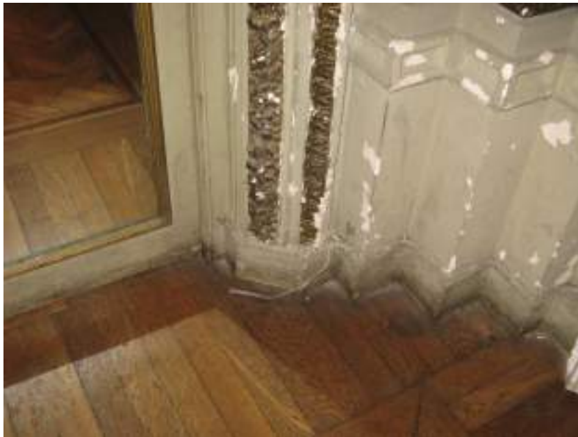
83-FALTANTE PARCIAL-INSTALACION OBSOLETA-PERDIDA DE RELIEVE
