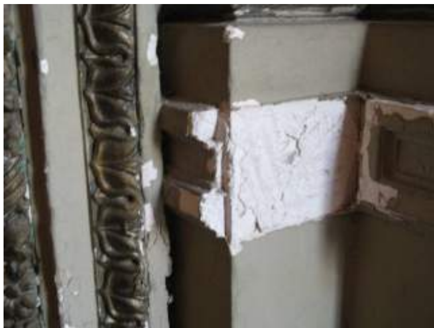
39-FALTANTE TOTAL-MATERIAL DISGREGADO
