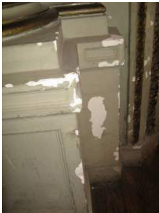
86-FALTANTE PARCIAL-INTERVENCION PRECEDENTE
