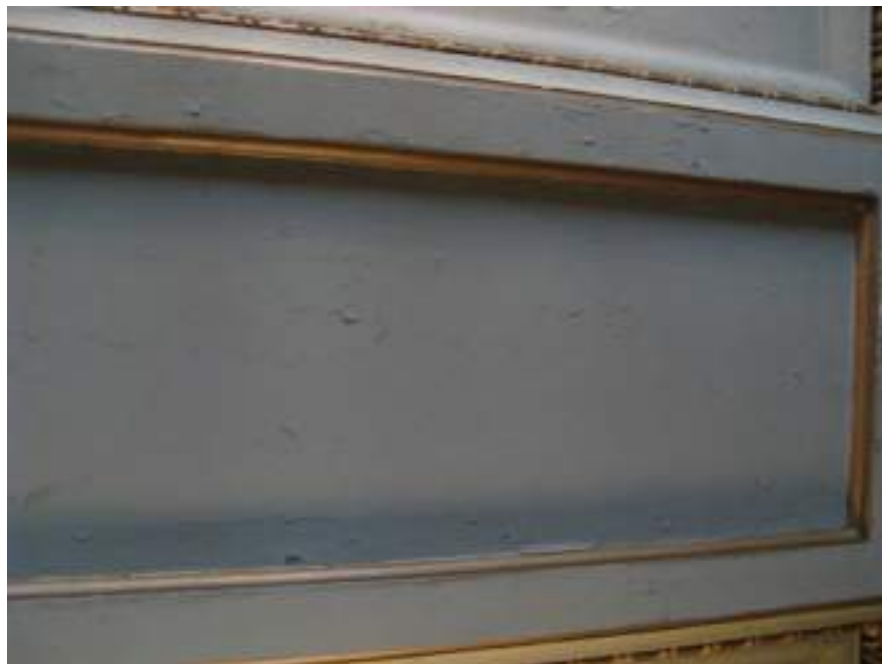
50-DESPRENDIMIENTO DE CAPA PICTORICA
