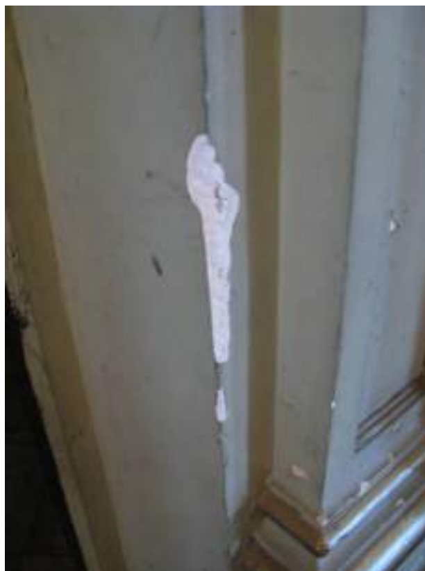
27-FALTANTE PARCIAL-PERDIDA DE RELIEVE
