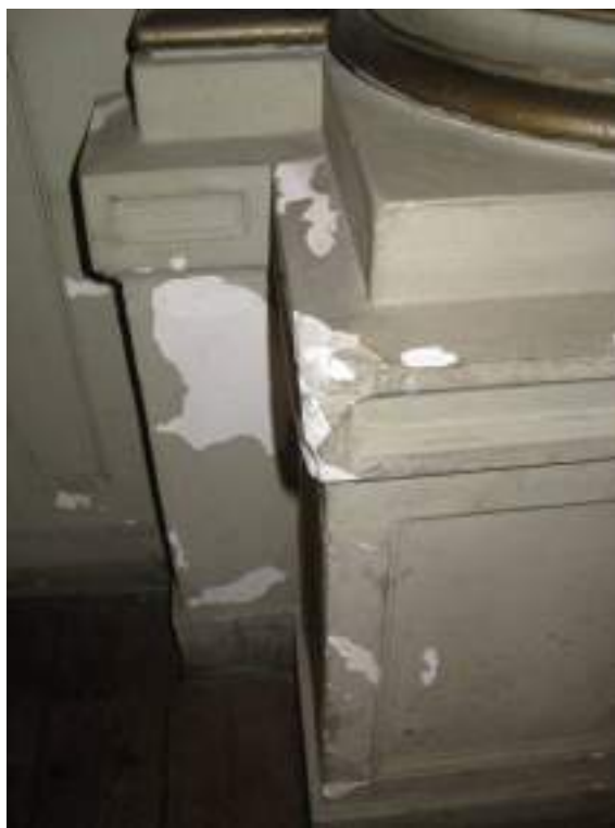
87-FALTANTE PARCIAL-DESPRENDIMIENTO CAPA PICTORICA
