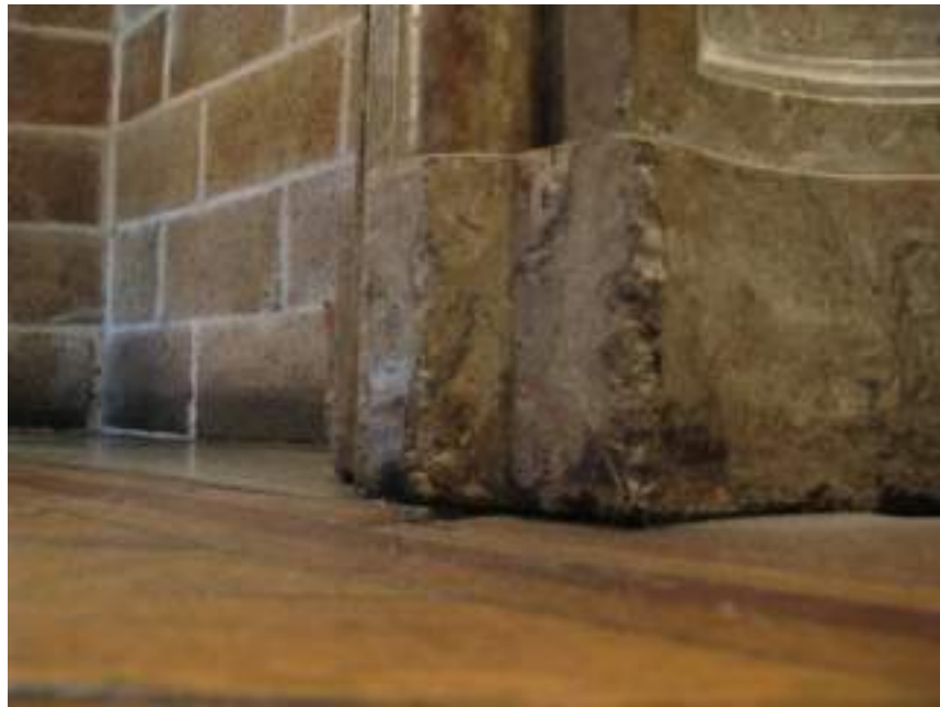
21-PERDIDA DE RELIEVE-SUCIEDAD SUPERFICIAL
