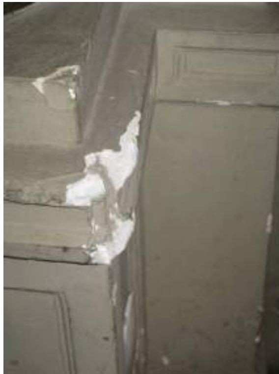
91-FALTANTE PARCIAL-PERDIDA DE RELIEVE
