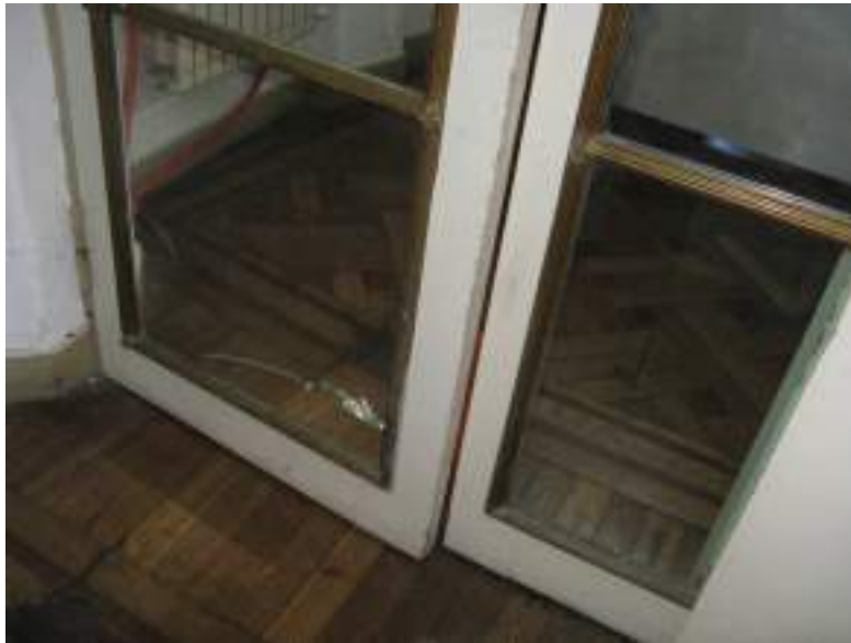
24-FALTANTE TOTAL-PERDIDA DE RELIEVE-VIDRIO ROTO
