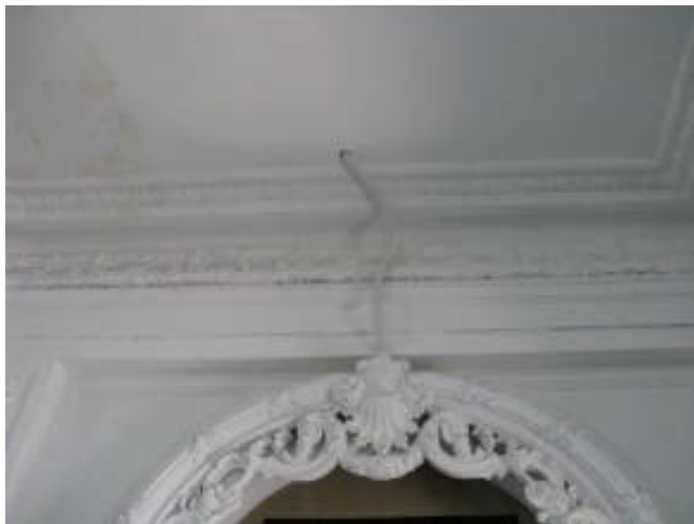
28-INSTALACION NO ORIGINAL-MANCHA DE HUEMDAD-PERFORACION
