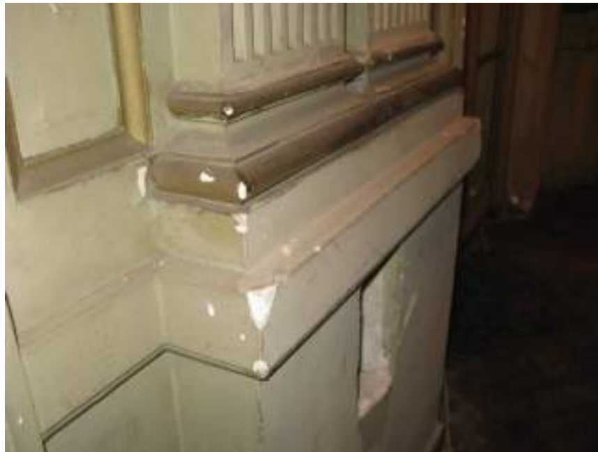
13-FALTANTE PARCIAL-PERDIDA DE RELIEVE
