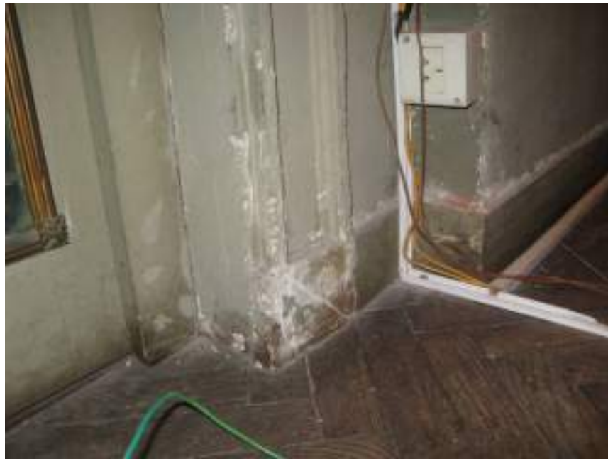
15-INSTALACION NO ORIGINAL-PERDIDA DE RELIEVE-ZOCALO FALTANTE
