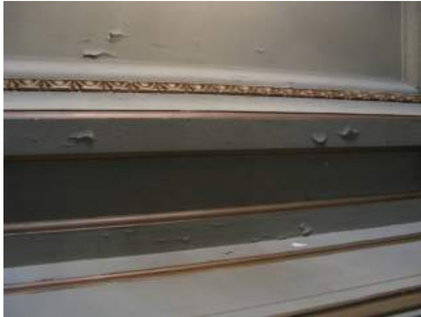
41-DESPRENDIMIENTO DE CAPA PICTORICA
