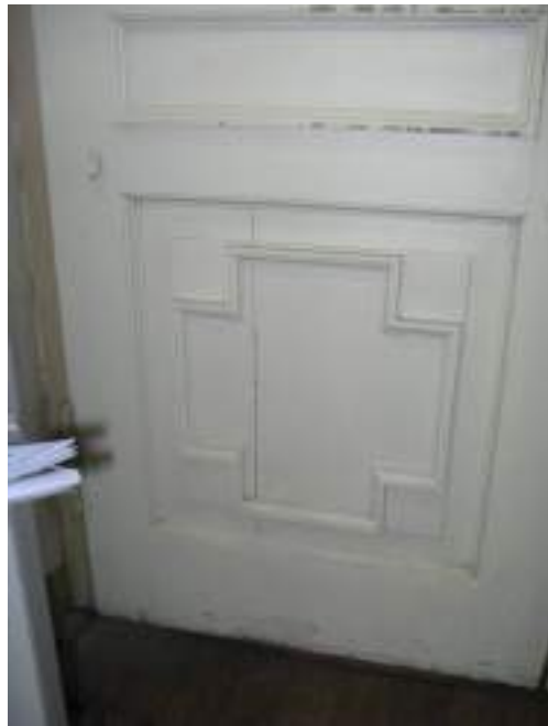
47-RAJADURA-RAYADURA-PERDIDA DE RELIEVE
