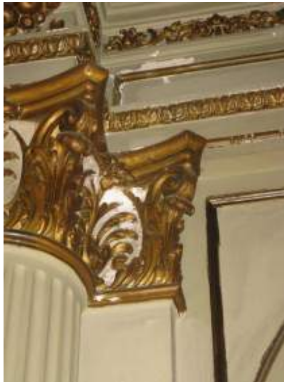
77-EFLORESCENCIA DE SALES SOLUBLES-MATERIAL DISGREGADO
