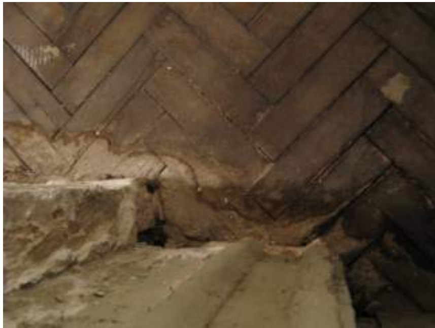
7-PA-JUNTAS ABIERTAS-MANCHAS DE HUMEDAD-PUTREFACCION
