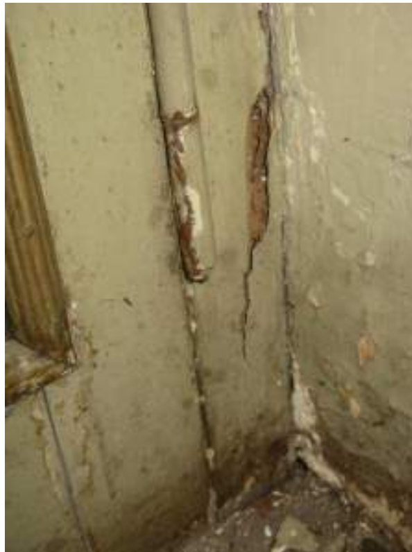
49-MATERIAL DISGREGADO-SALES SOLUBLES EN SUPERFICIE-PUTREFACCION
