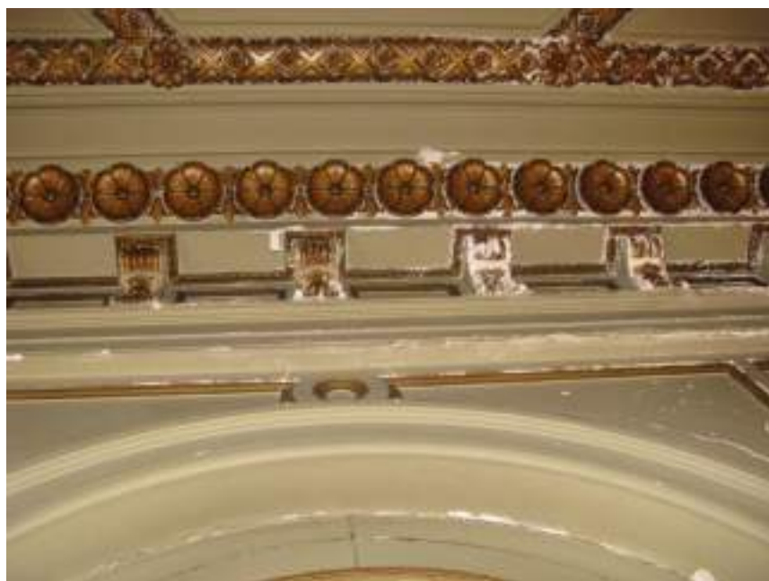
19- EFLORESCENCIAS DE SALES SOLUBLES-MATERIAL DISGREGADO
