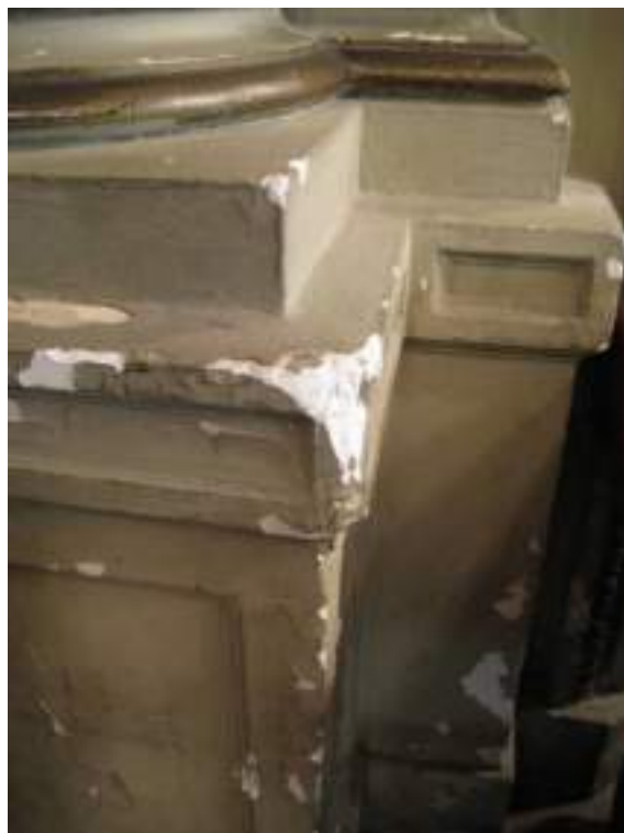
47-FALTANTE PARCIAL -PERDIDA DE RELIEVE
