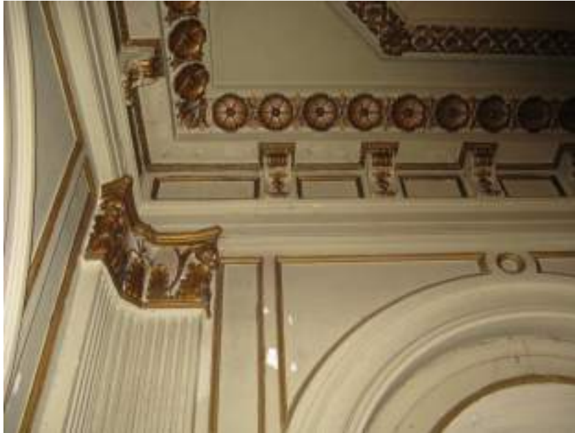
39-FISURAS-CAPA PICTORICA DISGREGADA
