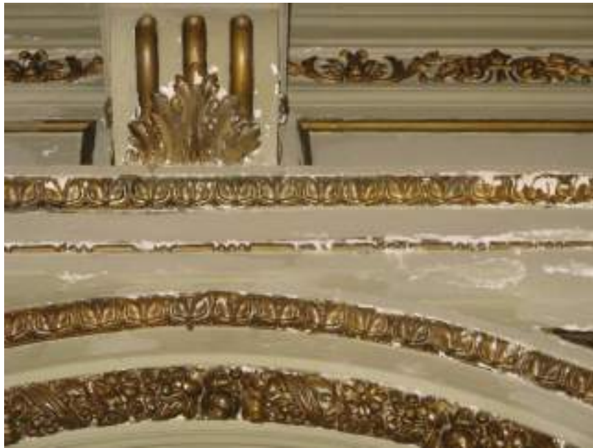
81-EFLORESCENCIA DE SALES SOLUBLES-MATERIAL DISGREGADO
