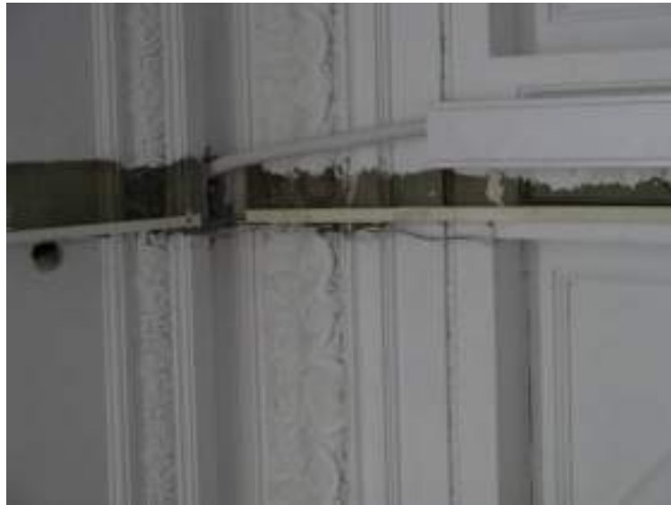
40-INSTALACION NO ORIGINAL-PERDIDA DE RELIEVE-PERFORACIONES
