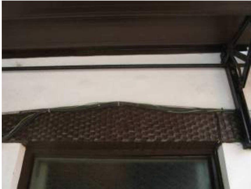
19-INSTALACION NO ORIGINAL
