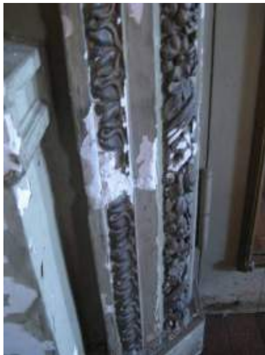
42-MATERIAL DISGREGADO-PERDIDA DE RELIEVE
