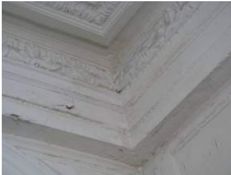
14-CAPA PICTORICA DISGREGADA-MANCHAS DE HUMEDAD-PERDIDA DE RELIEVE
