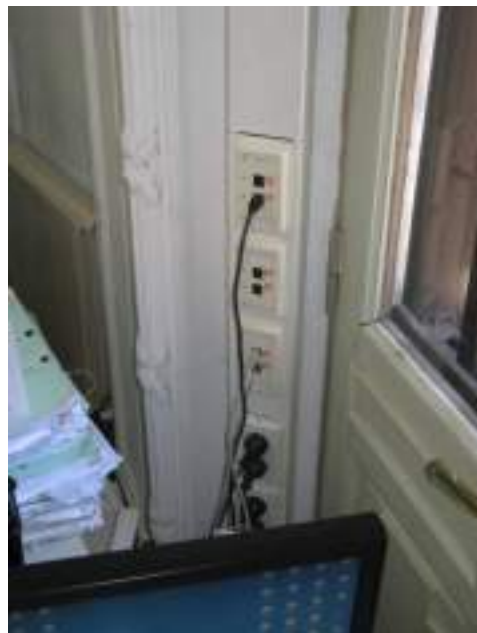
33-INSTALACION NO ORIGINAL
