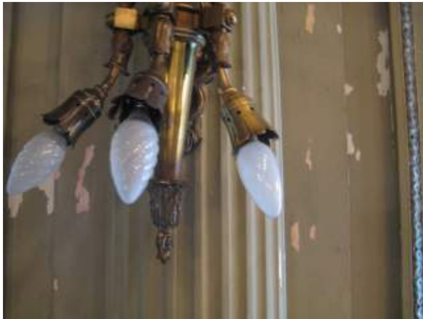
55-LAMPARA NO ORIGINAL-DESPRENDIMIENTO DE CAPA PICTORICA
