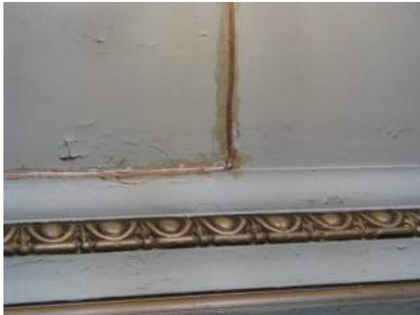
48-INSTALACION NO ORIGINAL-DESPRENDIMIENTO DE CAPA PICTORICA
