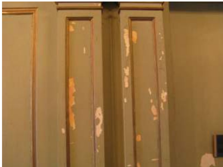
26-DESPRENDIMIENTO DE CAPA PICTORICA
