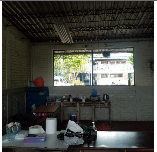
Se observa el hueco de las ventanas, se requiere cambio de techo, sistema eléctrico, sum. e inst. de platina, ventanas, refuerzo de defensas, enrejado metálico, cielo falso, pintura en general.
