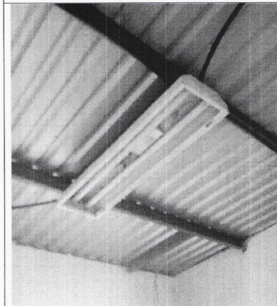
Estado del techo y de las instalaciones electricas de la infraestructura a readecuar.
