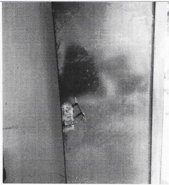
Condicion de las puertas a sustituir.
