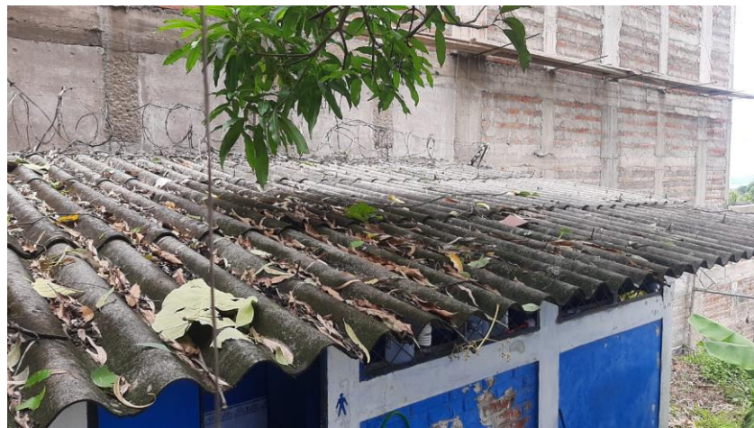
Servicios sanitarios: techos a cambiar
